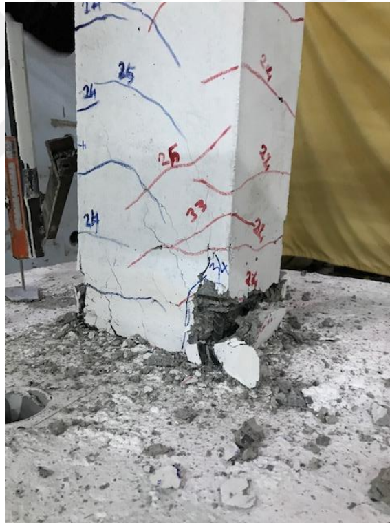
Şekil 3.5. Kolon temel birleşiminde oluşan ayrılma
