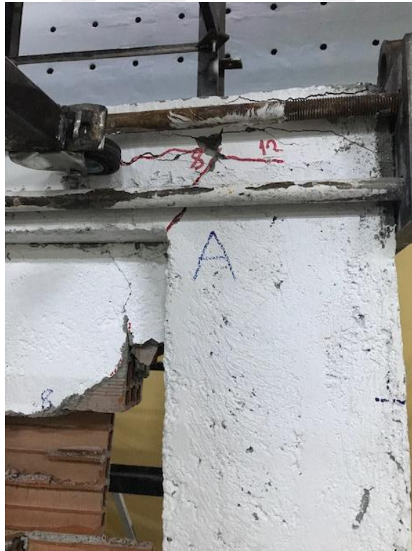
Şekil 3.10. On ikinci döngüde kesme çatlaklarının genişlemesi.
