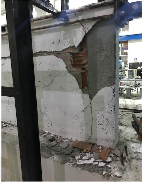
Şekil 3.9. Sıvada ve tuğlada gözlemlenen dökülmeler
