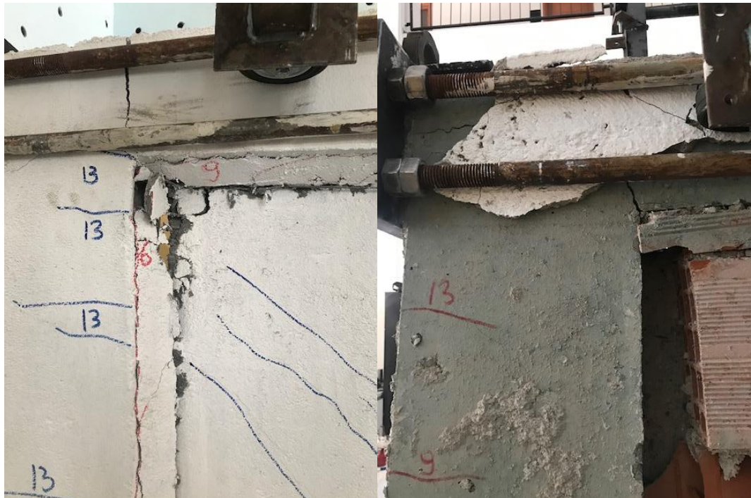
Şekil 3.16. Yirmi birinci döngü sonrasında kesme çatlaklarının oluşumu
