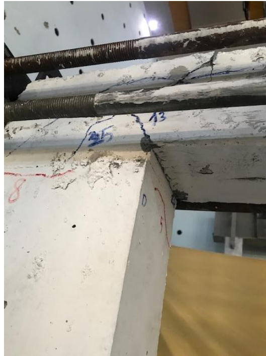
Şekil 3.4. Kolon kiriş birleşiminde oluşan diagonal çatlaklar
