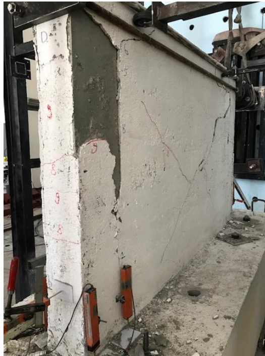
Şekil 3.13. On birinci döngüde meydana gelen sıva dökülmesi
