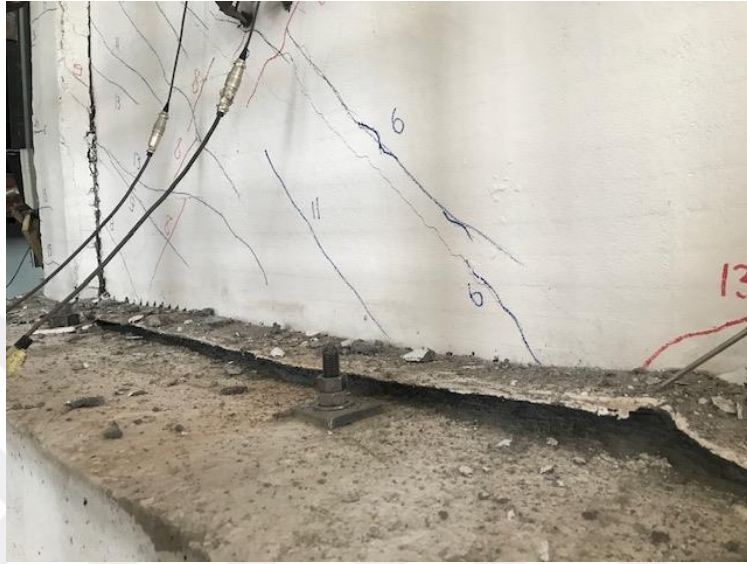
Şekil 3.17. Güçlendirme malzemesinin temel yüzeyinden ayrılması
