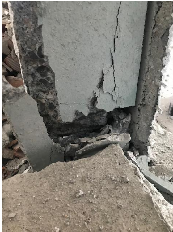
Şekil 3.18. Kolon temel birleşiminde pas payının dökülmesi
