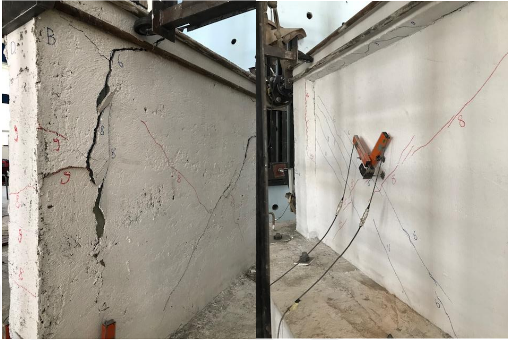
Şekil 3.12. Dokuzuncu döngü sonunda oluşan çatlaklar
