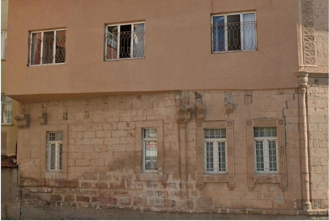
Şekil 4.60. Batı cephesindeki gönye çıkma ve zarar görmüş konsollar
