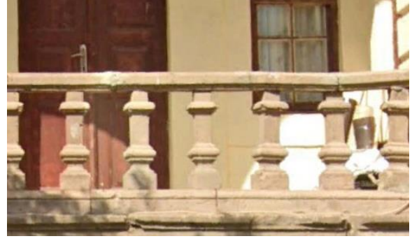
Şekil 5.40. Konut-18 taş balkon korkuluğu
