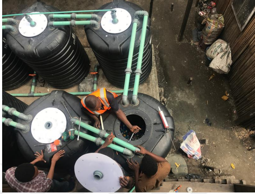
Şekil 2.16 Biyogaz tesisi (Swiss-Architects, 2022)
