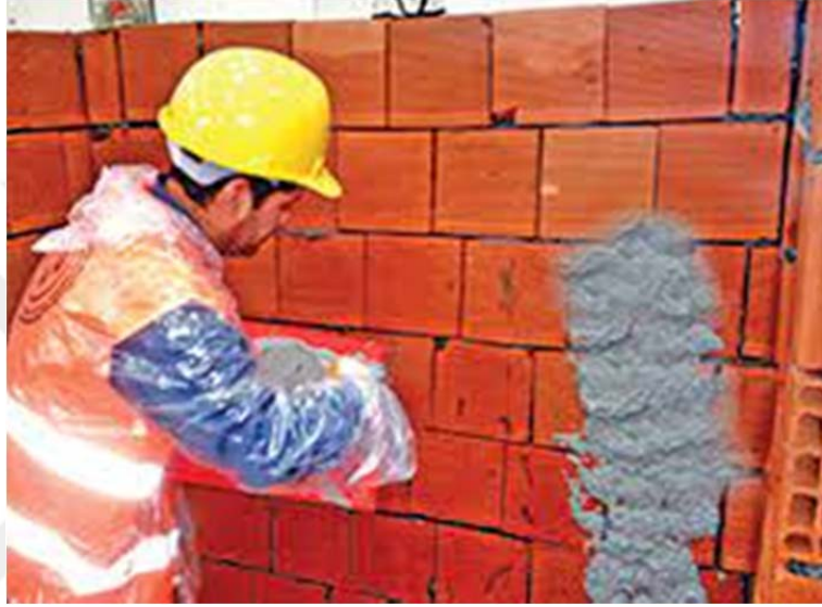
Şekil 3.39. Alçı - sıva işlerinde KKD kullanılmadan çalışılması uygunsuzluğu
