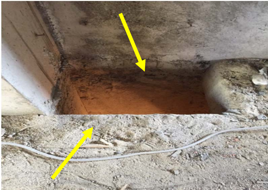
Şekil 4.7.a A inşaatı kapatılmamış şaft boşlukları
