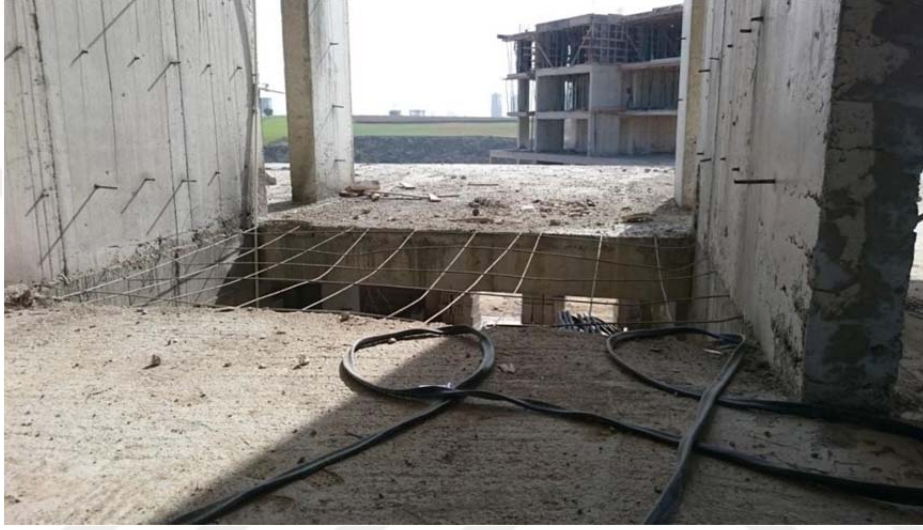
Şekil 4.26. B inşaatı asansör boşluğu uygunsuzluğu
