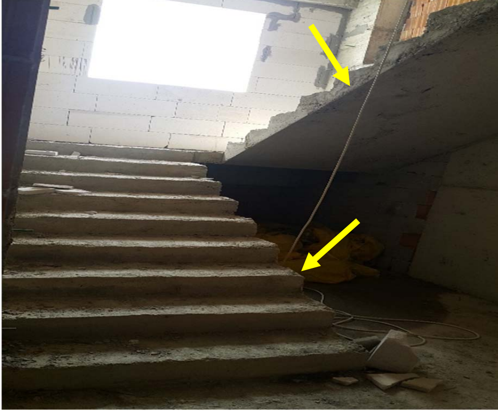
Şekil 4.14.b A inşaatı merdiven boşluklarının uygunsuzluğu
