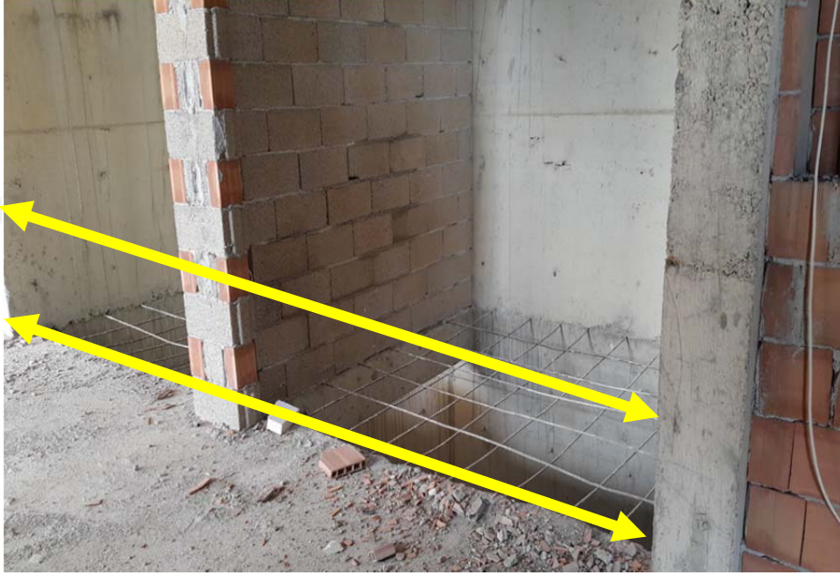
Şekil 4.10. A inşaatı asansör önü boşlukların uygunsuzluğu
