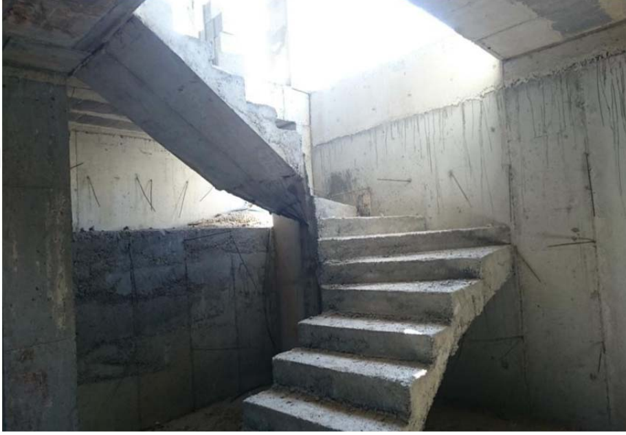
Şekil 4.28. B inşaatı merdiven kenarları uygunsuzluğu
