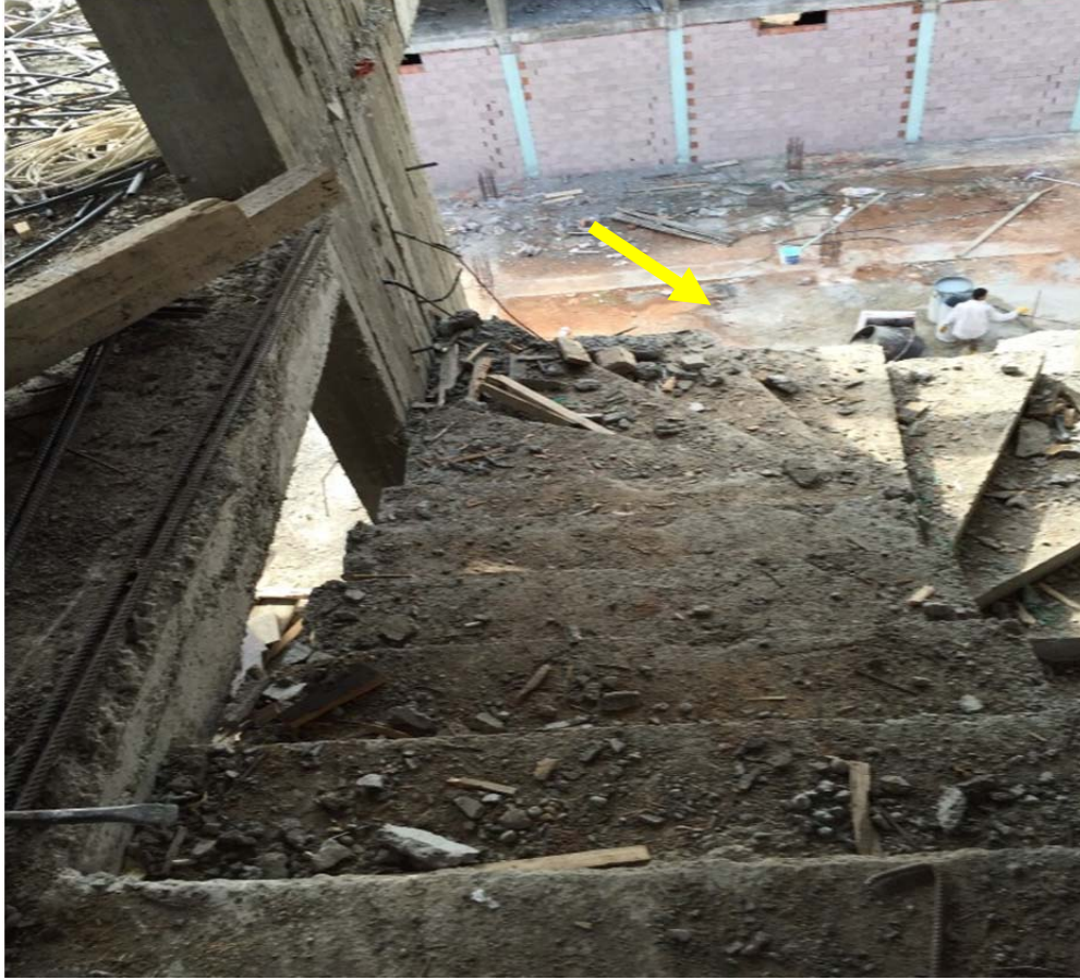
Şekil 4.13.a A inşaatı merdiven boşluklarının uygunsuzluğu
