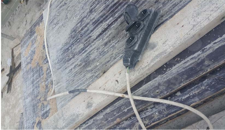
Şekil 4.33. b B inşaatı yıpranmış elektrik donanımları uygunsuzluğu
