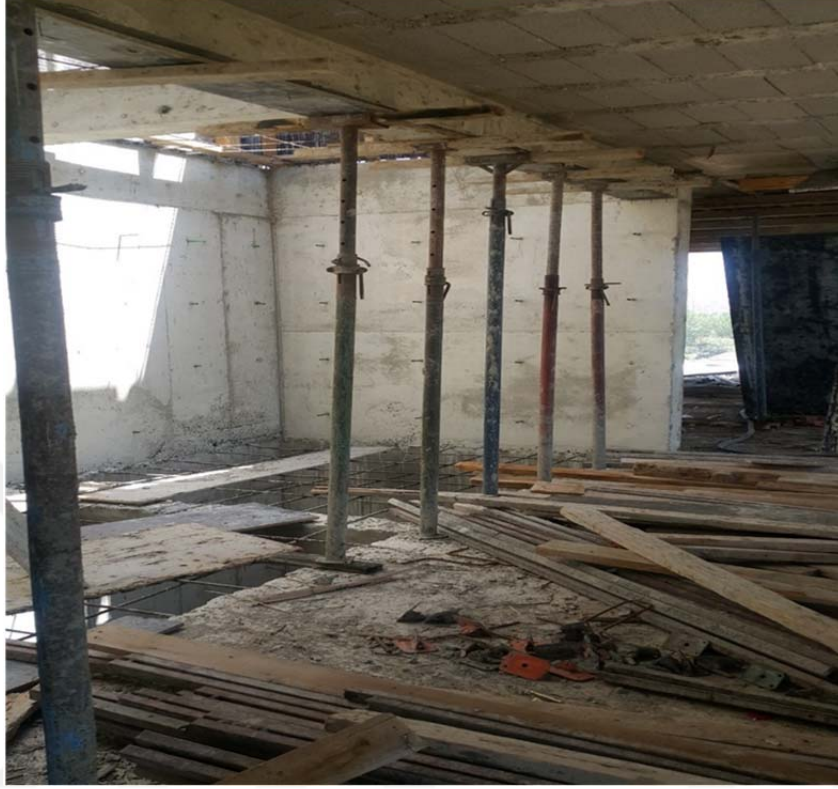
Şekil 4.35. b B inşaatı teleskopik direklerin uygunsuzluğu
