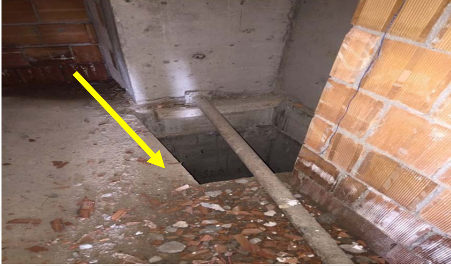
Şekil 4.8.b A inşaatı kapatılmamış şaft boşlukları
