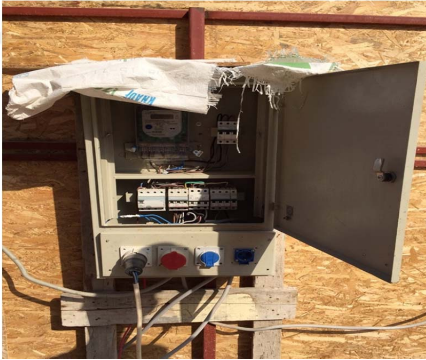
Şekil 4.30. B inşaatı elektrik panosu uygunsuzluğu
