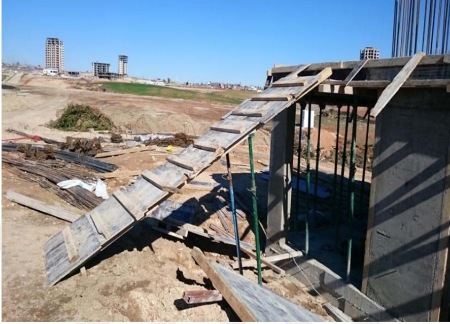
Şekil 4.22. B inşaatı tabliye üzeri merdiven uygunsuzluğu
