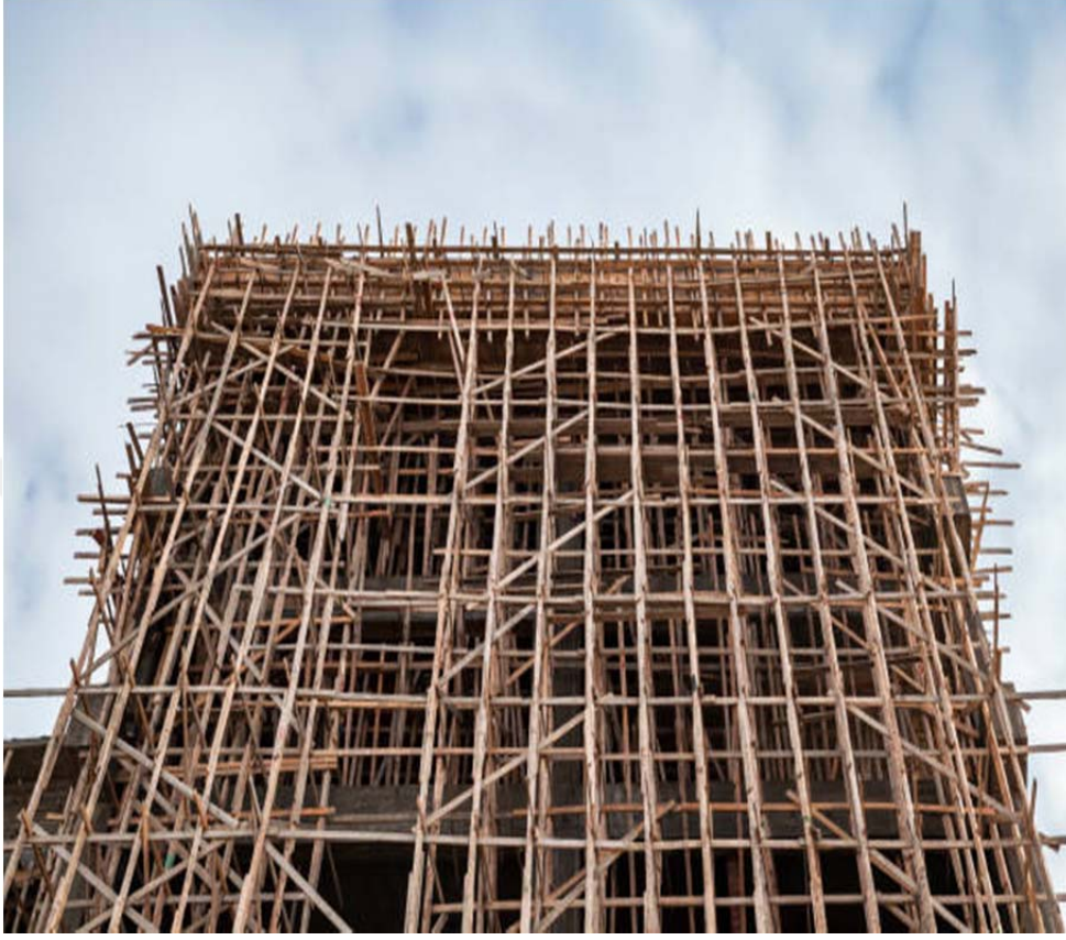
Şekil 3.19. Uygun olmayan ahşap cephe iskelesi örneği
