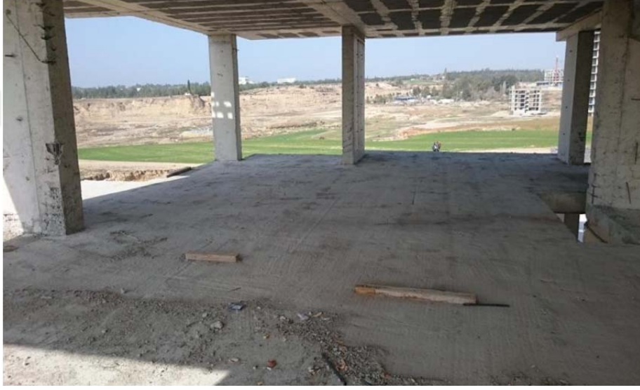
Şekil 4.24. B inşaatı kat kenarı boşluklarının uygunsuzluğu
