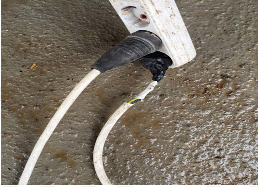
Şekil 4.32. a B inşaatı yıpranmış elektrik donanımları uygunsuzluğu
