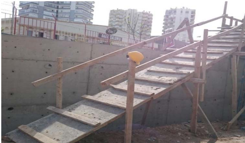
Şekil 4.23. İnşaat tabliye üzeri uygun merdiven örneği
