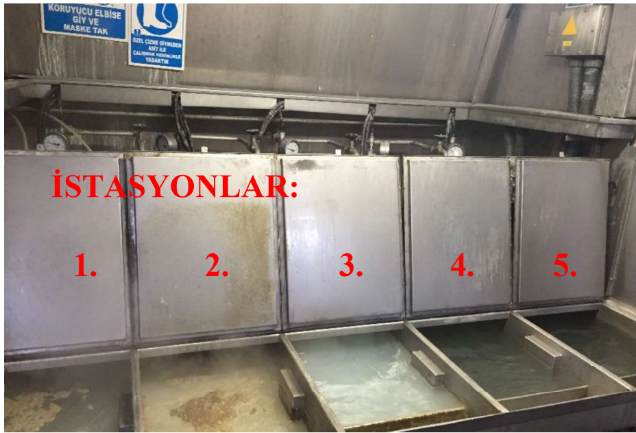
Şekil 17 İstasyonlarda oluşan kirleticilerin gözlemlenmesi
