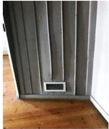
Şekil 6.39: Zemin kat iç mekan kanal çıkışı
