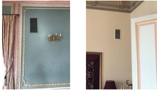
Şekil 8.42: Odalarda cephe duvarlarına yerleştirilen emiş menfezleri
