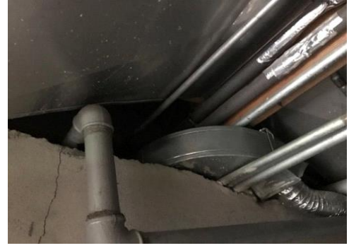
Şekil 6.43: Tesisat odası havalandırma kanalı çıkışları
