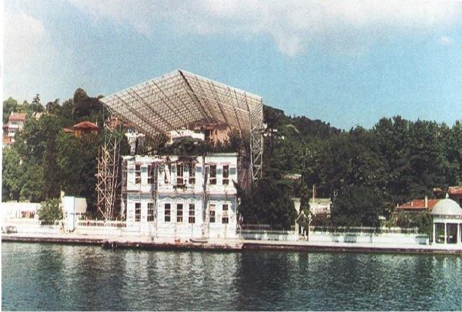
Şekil 8.21: Sait Halim Paşa Yalısı 1995 yangını sonrası koruma amaçlı yapılan geçici çatı sistemi ile denizden görünüşü Nisan 1996 (Avunduk, 2002)
