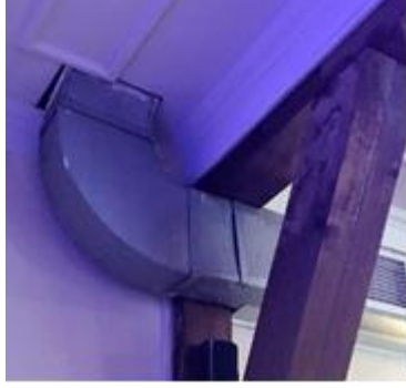
Şekil 6.34: Bodrum kat seminer odası hava kanalı görünüşü
