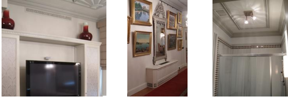
Şekil 7.31: Birinci kat merdiven holü, wc, yatak odası VRF ve havalandırma menfezleri (Alper)
