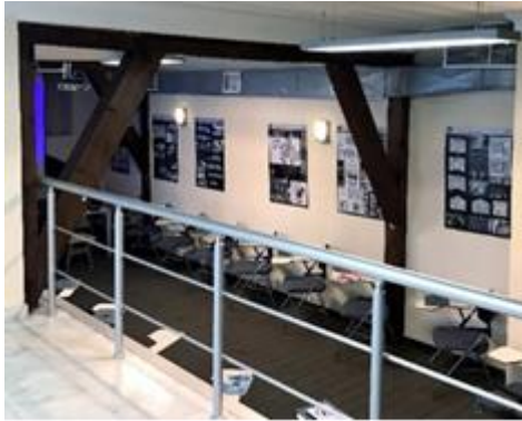
Şekil 6.32: Bodrum kat seminer odası hava kanalı görünüşü
