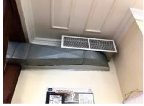
Şekil 6.35: Bodrum kat seminer hava kanalı görünüşü
