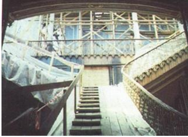
Şekil 8.22: Harem girişi merdiven holü enkaz kaldırıldıktan sonra görünüşü. Nisan 1996 (Avunduk, 2002)
