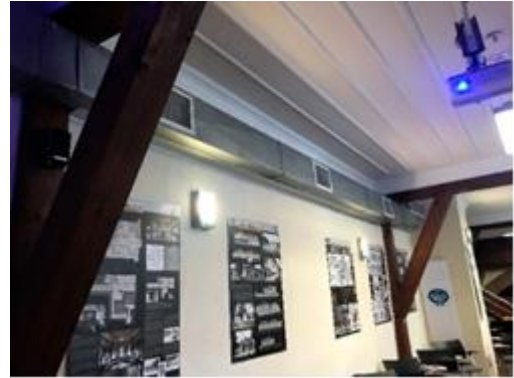
Şekil 6.33: Bodrum kat seminer odası hava kanalı görünüşü
