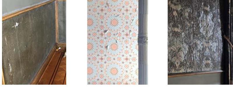
Şekil 8.43: Duvarlarda oluşan deformasyonlar
