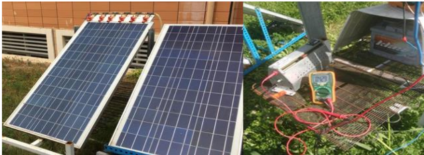
Şekil 3.4. Panel soğutma çalışması (Kerem, 2020)
