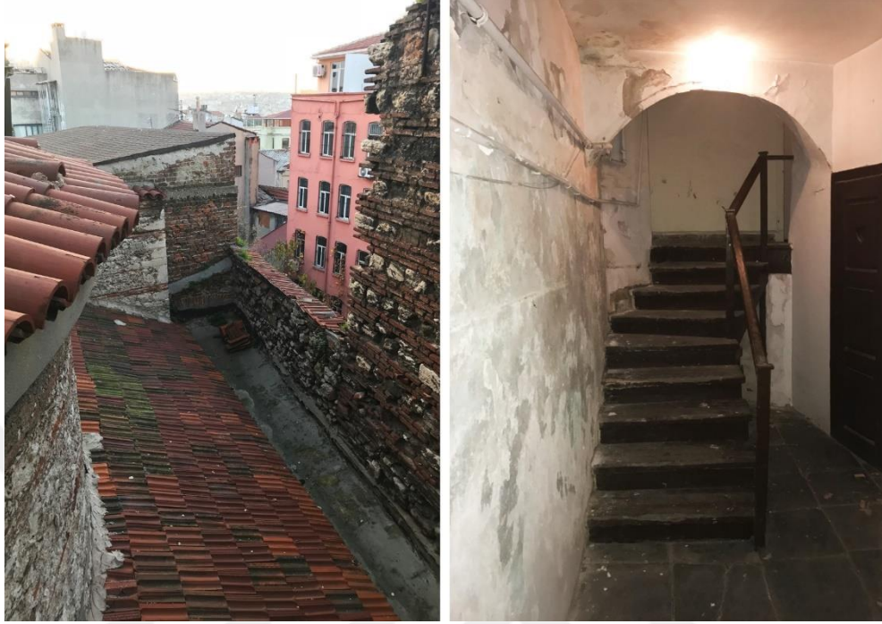
Şekil 4.82 : Solda sur duvarı ve apsis arasındaki geçit mekânı çatısı, sağda mekân içerisinde görülen bozulmalar (Güçlü Prifti, 2017).
