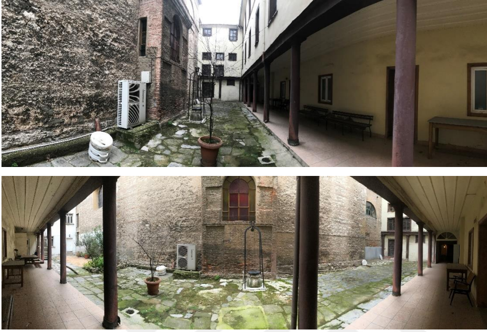
Şekil 4.80 : İkinci avlu zemininde yosunlanma (Güçlü Prifti, 2017).
