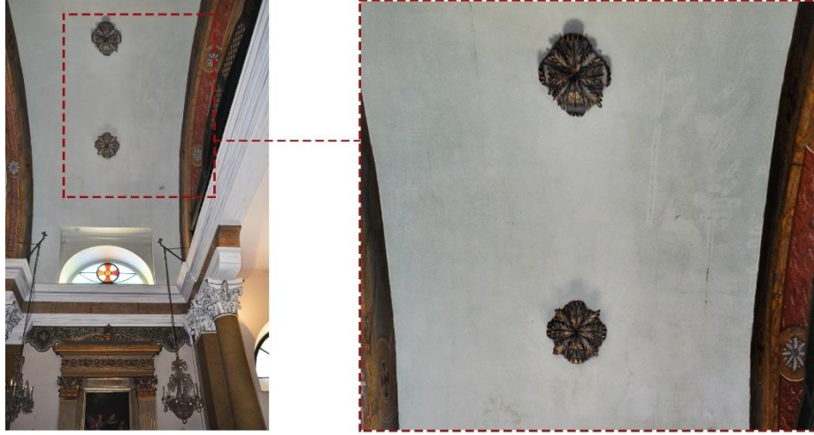
Şekil 4.74 : Naos tavanında sıva çatlakları (S1'-S2' sütunları arası) ve üzerinde yapılmış onarım izleri (Güçlü Prifti, 2017).
