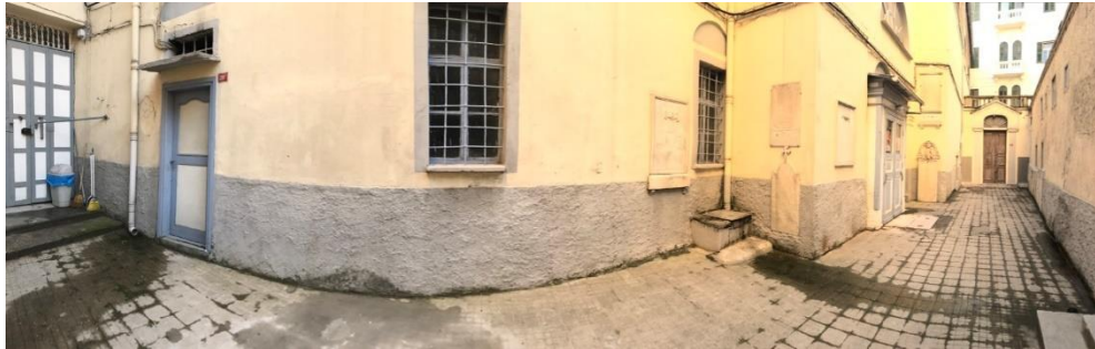
Şekil 4.79 : Birinci avlu zeminine ulaşan yağmur suyu (Güçlü Prifti, 2016).
