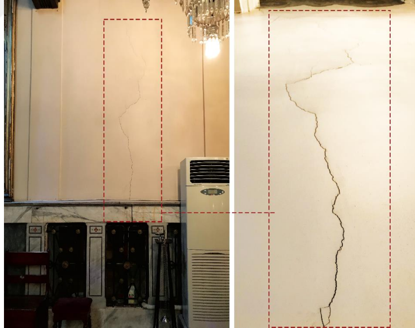
Şekil 4.72 : Bema kuzeydoğu duvarı üzerindeki strüktürel çatlak (Güçlü Prifti, 2017).
