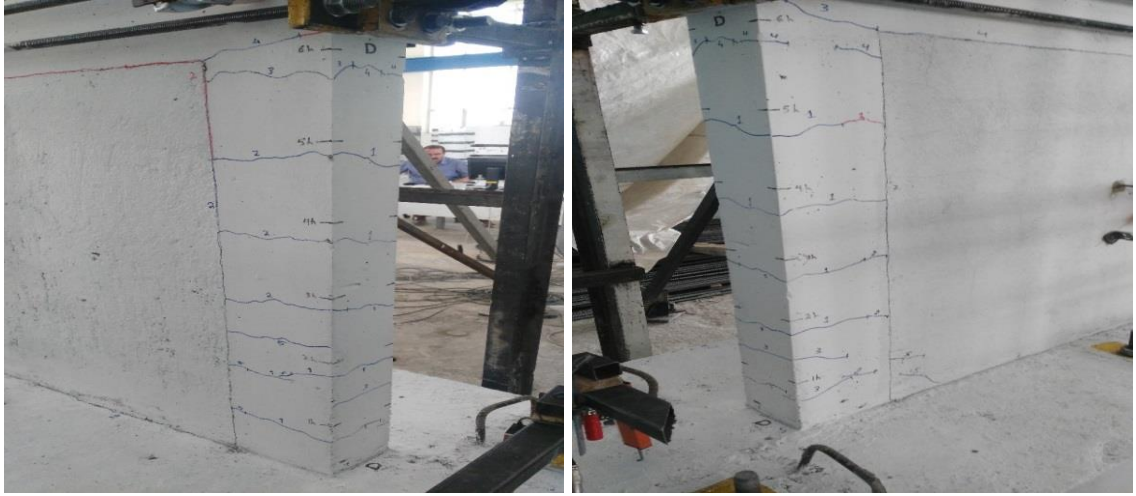
Şekil 4.22. 5. döngü sonunda çatlak ve ayrılma durumu
