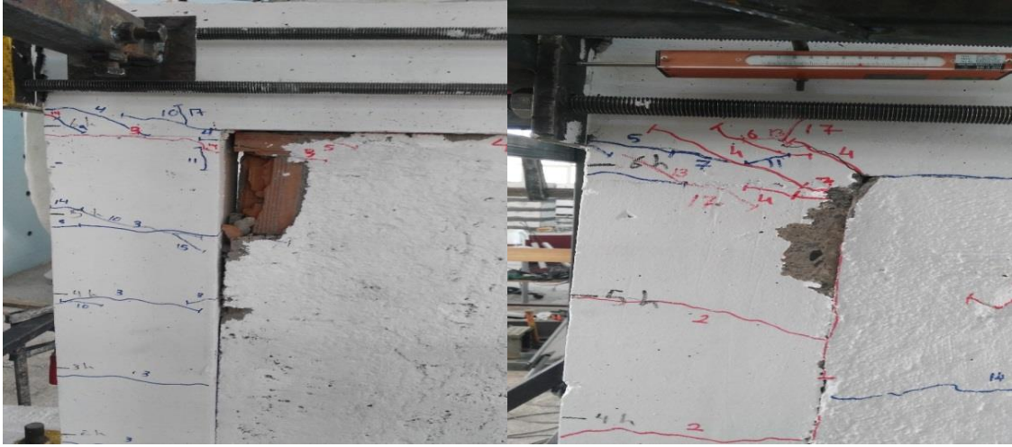
Şekil 4.11. 17. döngü sonunda oluşan çatlaklar ve dökülmeler
