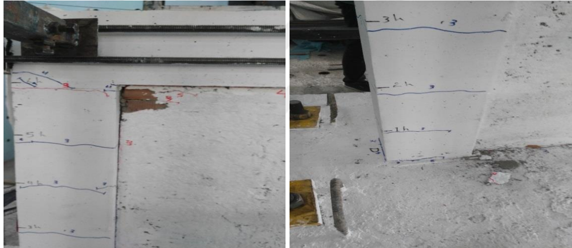
Şekil 4.9. 7. döngü sonunda oluşan çatlaklar ve dökülmeler
