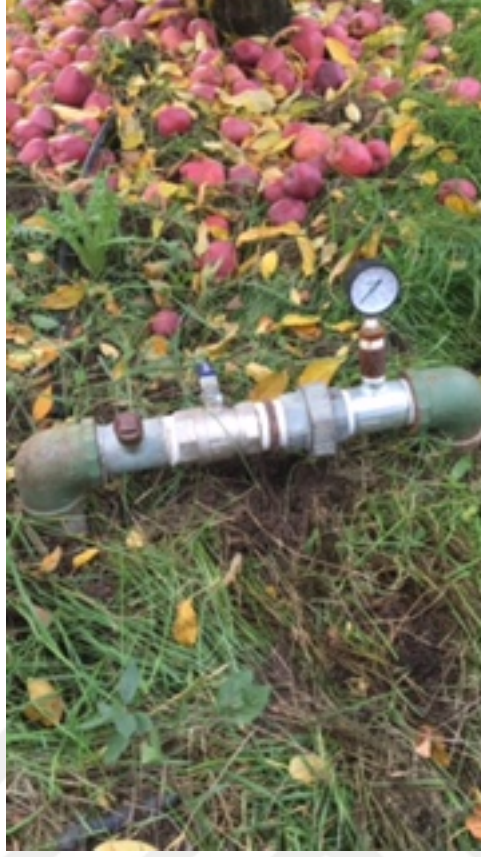
Şekil 3.12. Dağıtım boru hattı manifold
