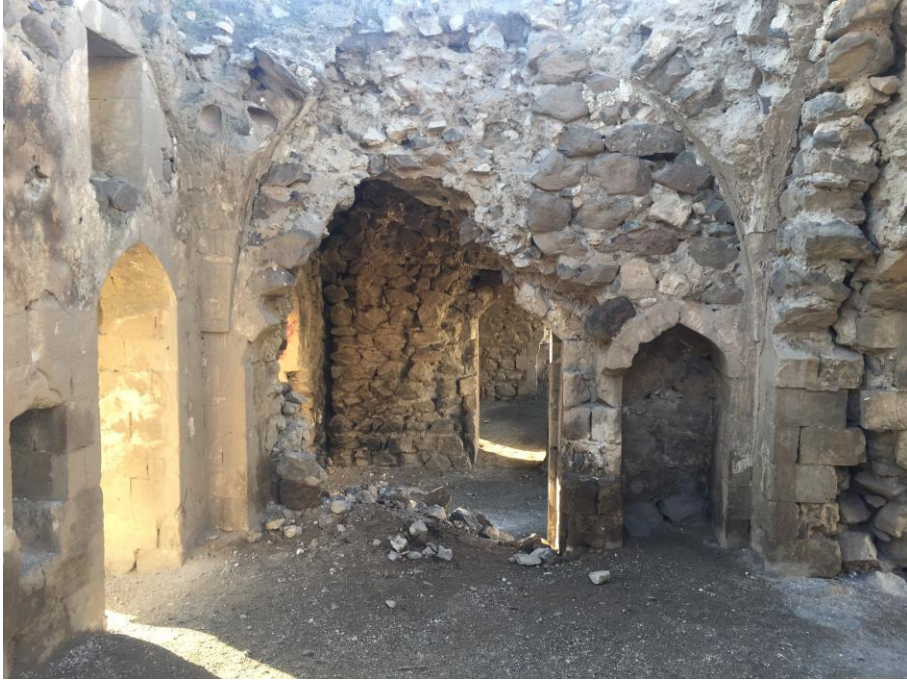
Resim 32: Konuk odasının yıkılan duvarından görünen eyvanlı bölüm.
