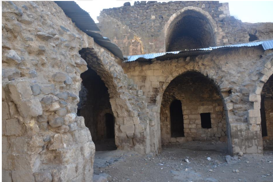
Resim 44: Yeraltı sularının yapı temellerinden başlayarak yükselmesi ile oluşan bozulma (Batman, Mor Kuryakos Manastırı).
