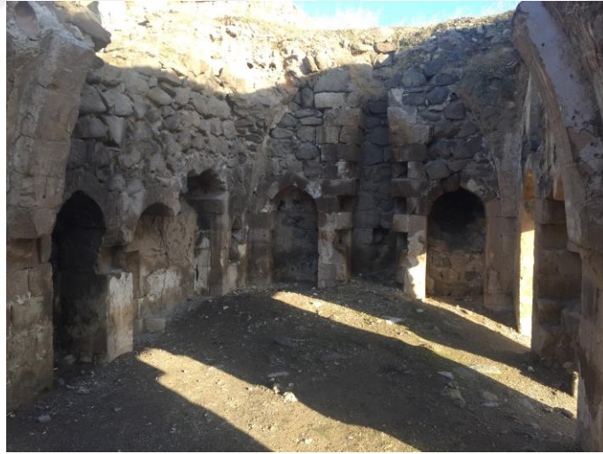
Resim 42. Atmosferik etki ve depremden dolayı 18 nolu konuk odasının çöken üst örtüsünden görünüm.
