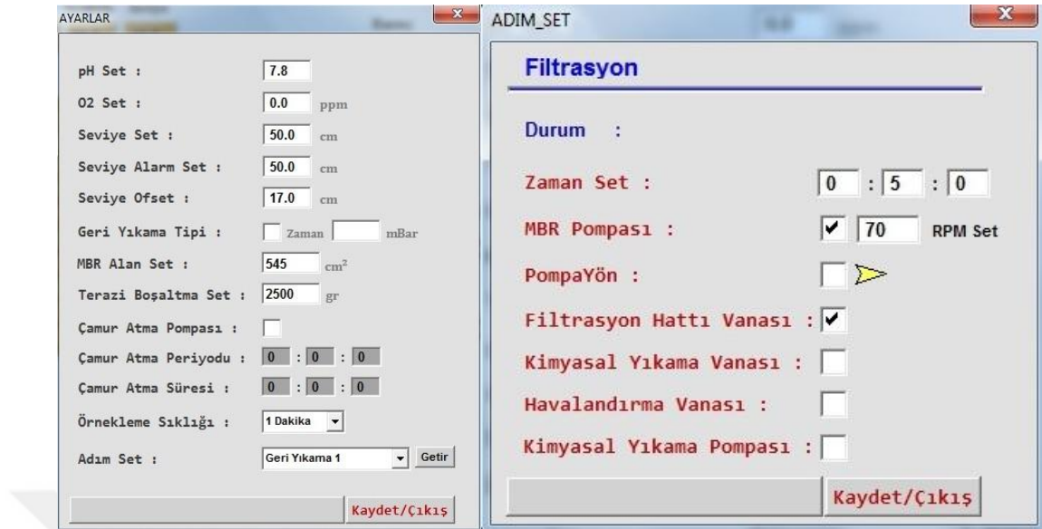
Şekil 15. SCADA işletim parametreleri kontrol ekranı
