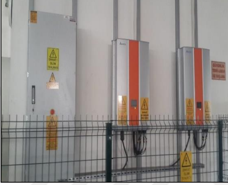
Şekil 3.3 İzmir-Gaziemir pano ve invertörler.
