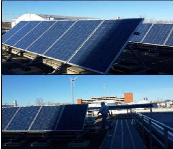
Şekil 3.19 Kanada-Edmonton güneş enerji sistem panelleri.
