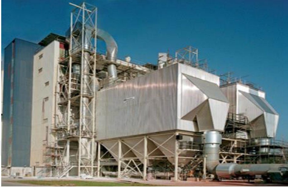
Şekil 5.29 Bir termik santralde elektrofiltre tesisi [22]
