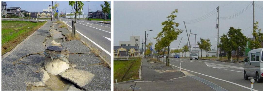
Şekil 2.5 2004 Niigataken-Chuetsu depreminde sıvılaşmış zeminlerde hasar almış altyapılar.
