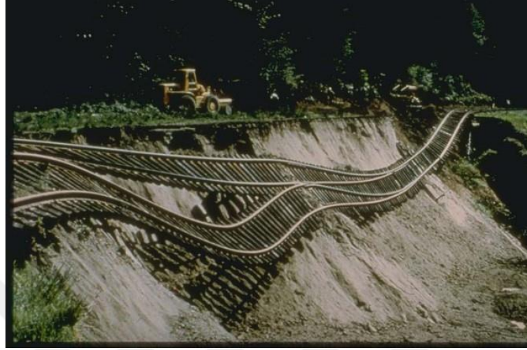
Şekil 2.6 1965 Puget Sound Depreminde heyelan sonucunda hasar almış demiryolu.
