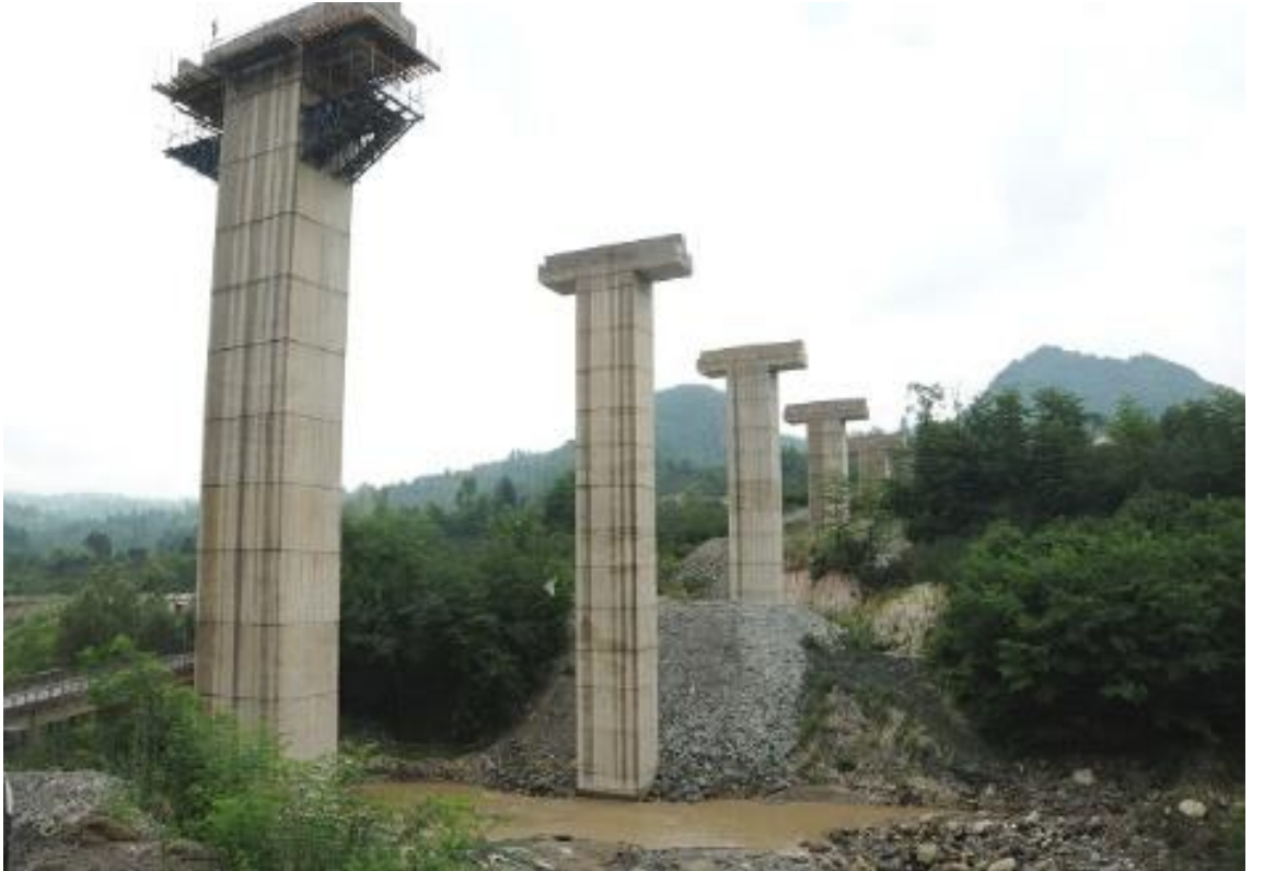
Şekil 1.2. Zemin kotunun farklılığından dolayı kısa kolon kusuru olan viyadük ayağı[3]
