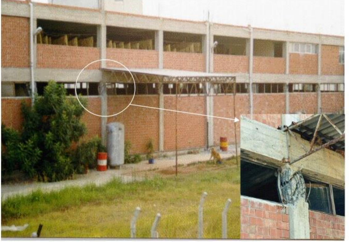
Şekil 1.1. Deprem etkisiyle hasar gören kısa kolon elemanları [2]
