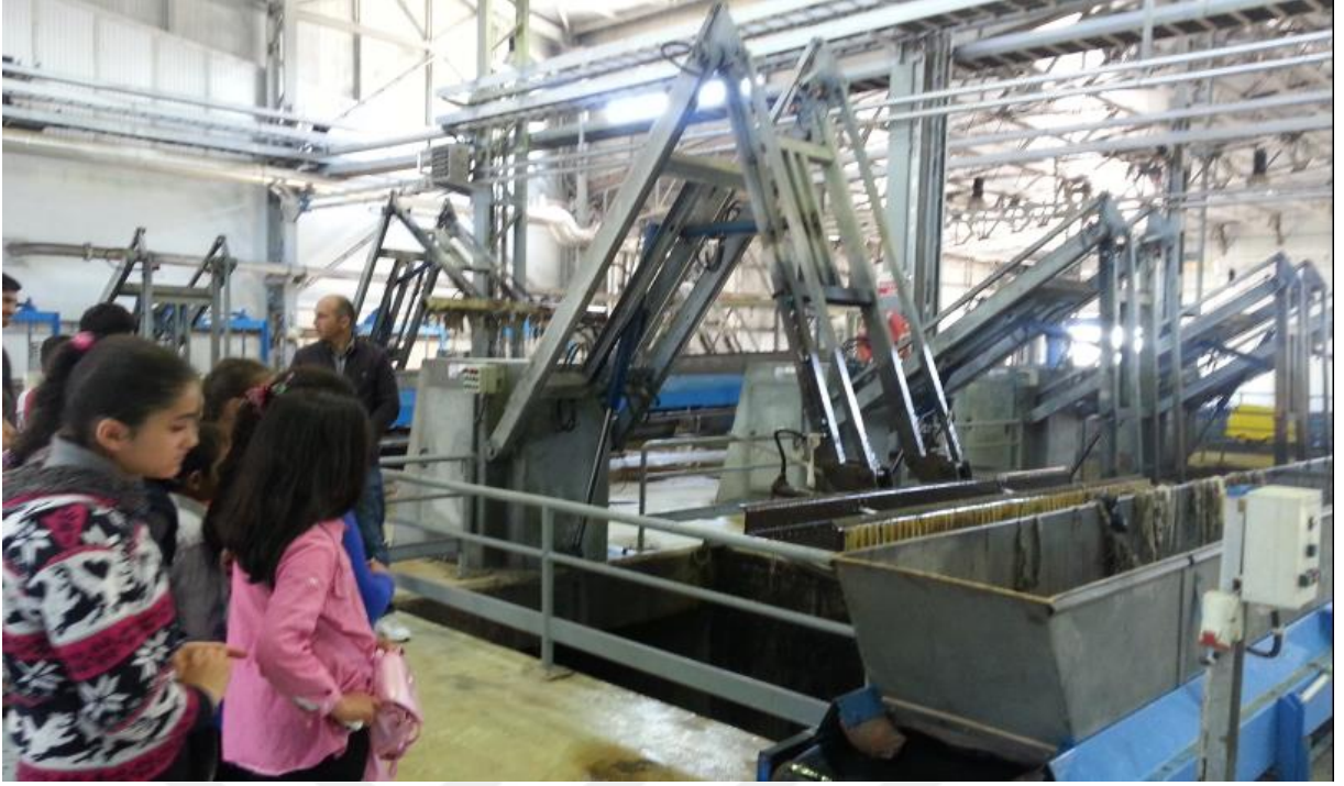
Atık Su Arıtma Tesisi
