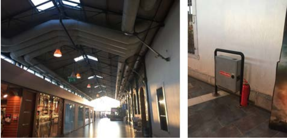
Şekil 107. Yapı İçinde Eklenen Tesisat Sistemleri ve Yangın Dolabı Kaynak: G. Büke Doğru'nun Kişisel Arşivinden Alınmıştır.
