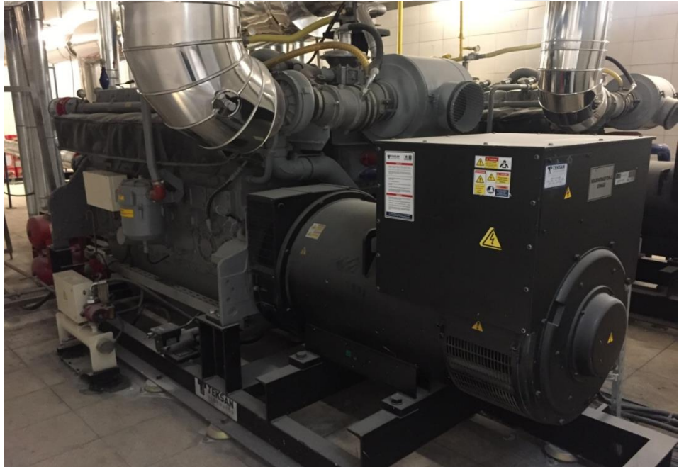
Şekil 3.4 2x425kW e gücünde paralel çalışan doğalgaz motor/alternatör setleri.
