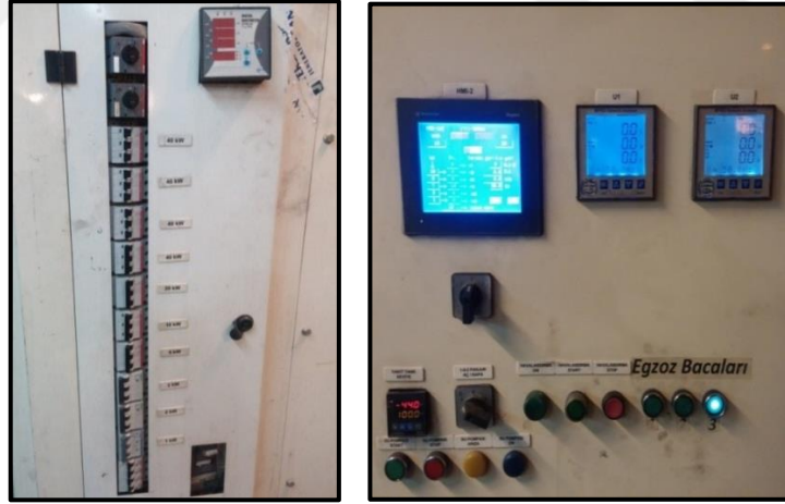
Şekil 4.7 Yük bankası kontrol paneli
