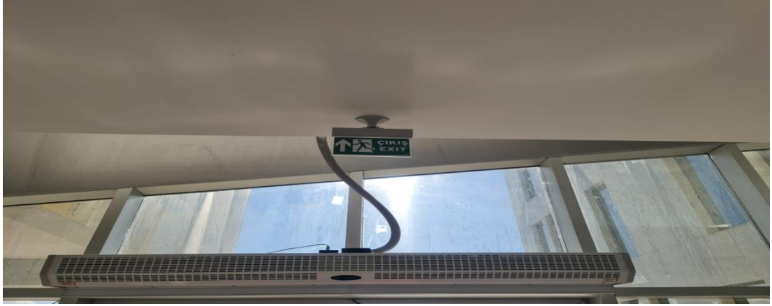
Şekil 4.11: ÇAKÜ Kütüphane Havalandırma Sistemi
