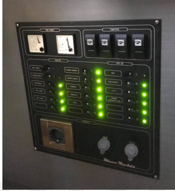
Şekil 167: Mazu Yachts 82, Elektrik Panosu
