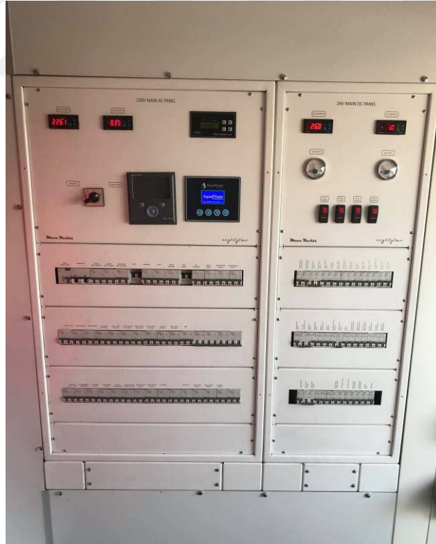
Şekil 168: Mazu Yachts 82, Elektrik Panosu
