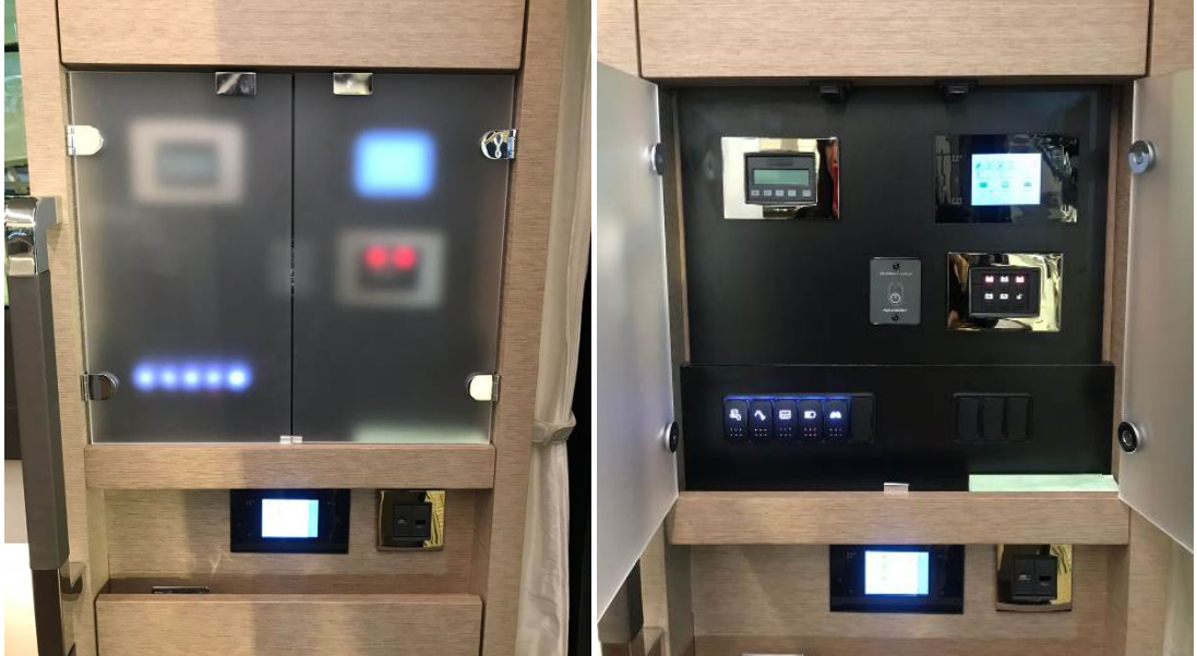
Şekil 225: Prestige 590, Elektrik Panosu
