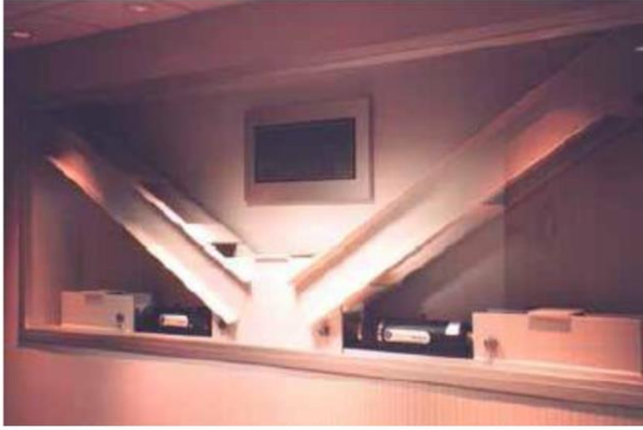
Şekil 1.29. Kurulumu tamamlanmış viskoz sönümleyici [34]
