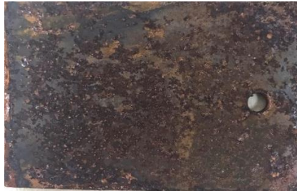
Şekil 3.23. Korozyona uğramış metal.
