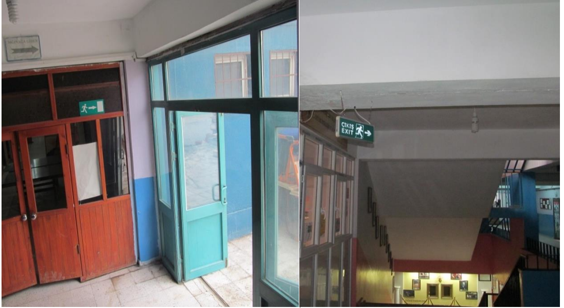
Şekil 4.12. Acil Çıkış Kapıları ve Kaçış Levhaları
