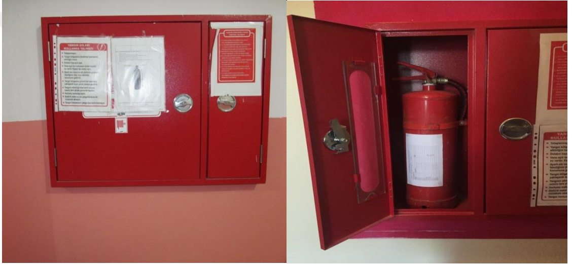
Şekil 4.10. Yangın Dolapları ve Tüpleri
