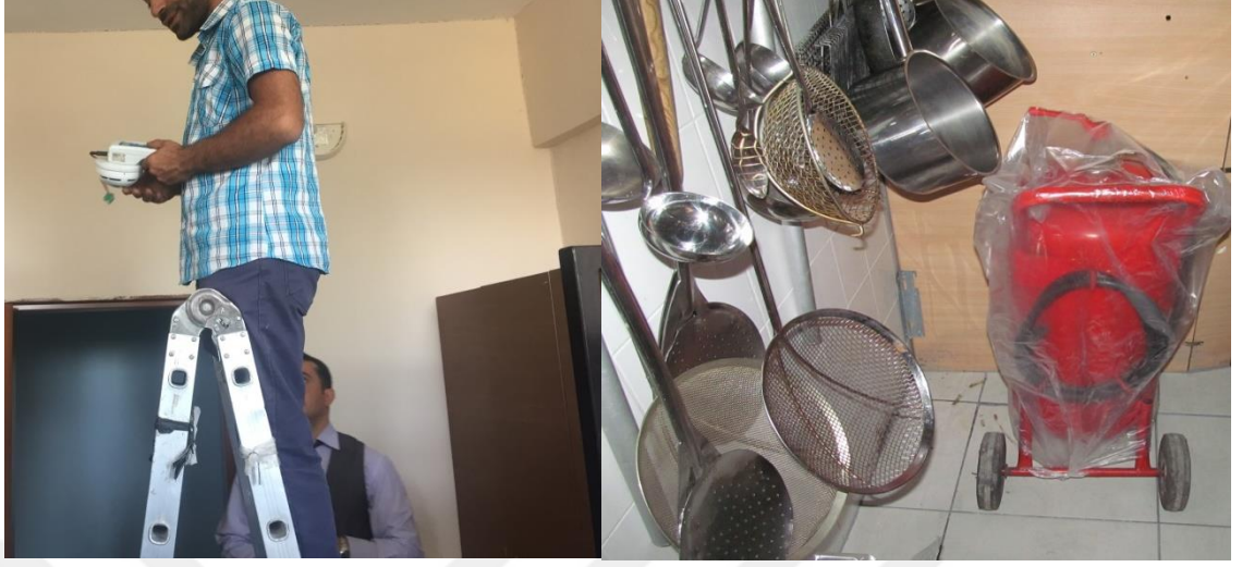
Şekil 4.11. Yangın Dedektörü ve Yangın Butonu
