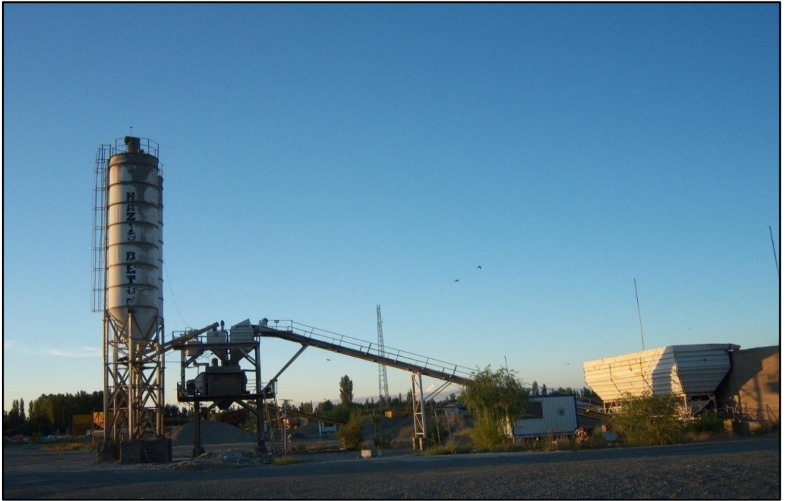
Foto 42:Iğdır Belediyesi'nin hazır beton tesislerinden bir görünüm, Kışla Mahallesi
