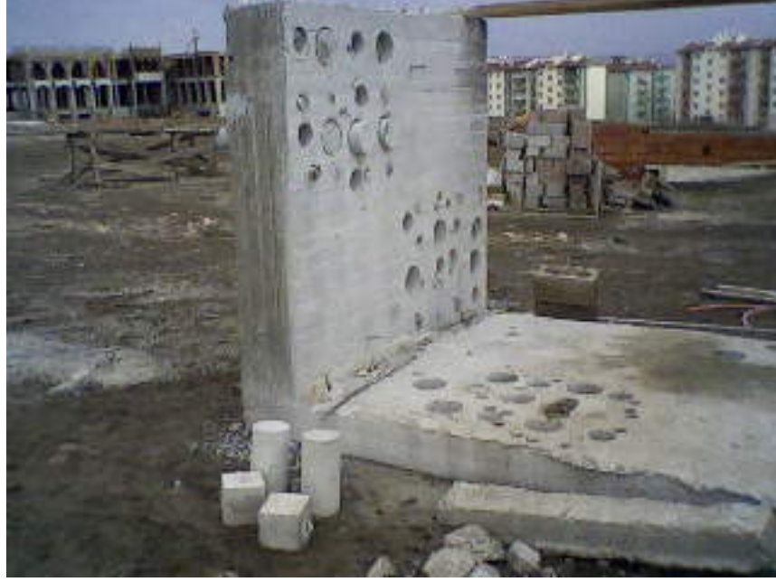
Şekil 5.18. Perde ve döşeme elemanından karot alındıktan sonra genel görünüş.
