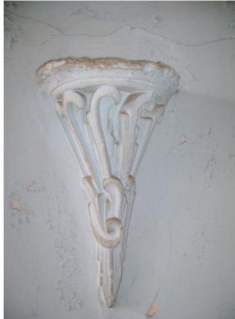
Fotoğraf: 38 Bey Sokağı Osman Paşa Konağı No.23, Zemin katın kuzeydoğu köşesindeki odada bulunan alçı mumluk
