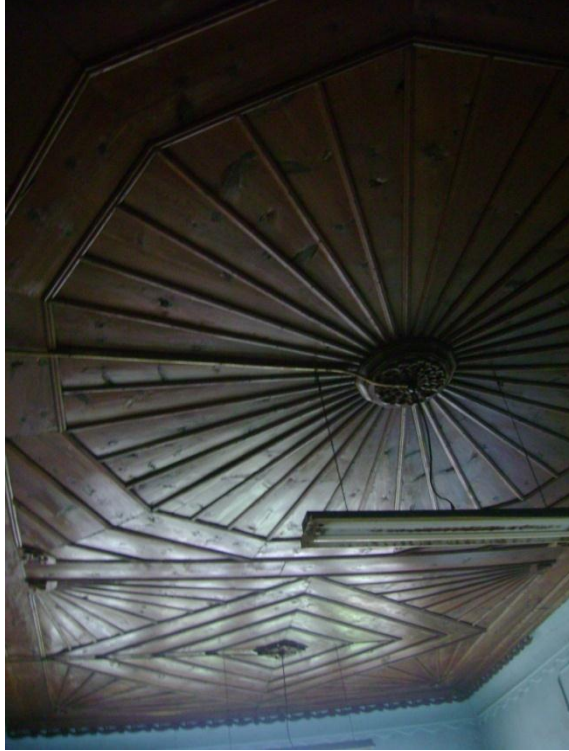
Fotoğraf: 44 Bey Sokağı Osman Paşa Konağı No.23, Birinci katın sofasının tavanı
