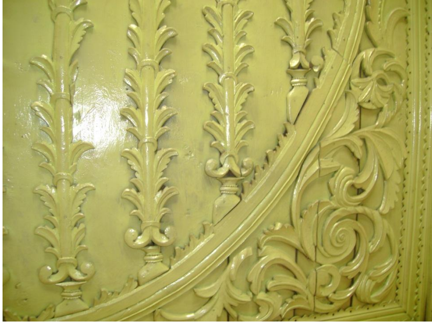
Fotoğraf: 92 Bey Sokağı No.44-44A/25, Birinci katın güneydoğu köşesindeki odanın tavanı
