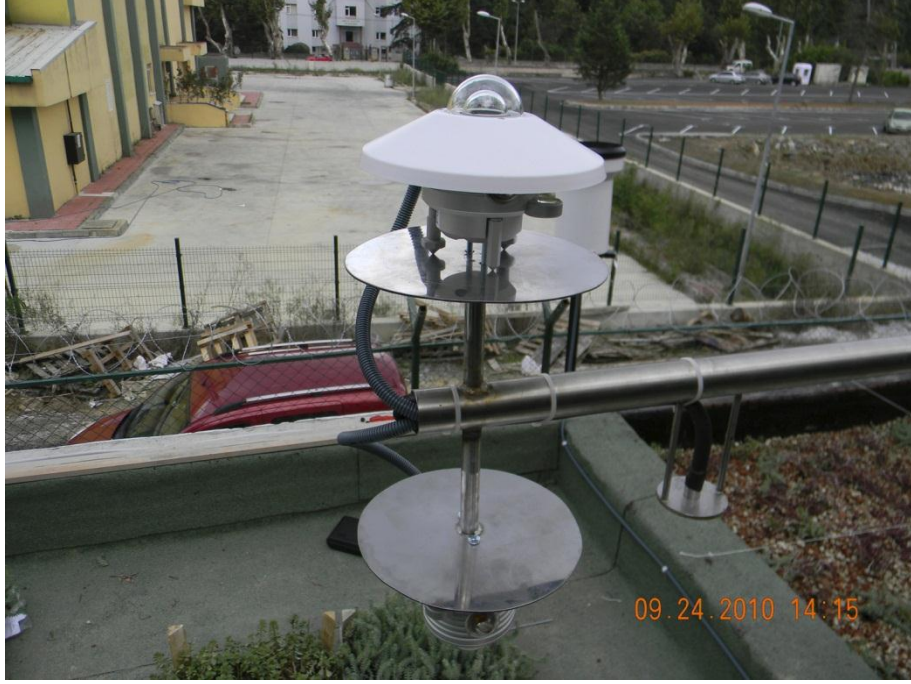
Ek-7.2.3 - Çatı yüzeyinde bulunan piranometreler
