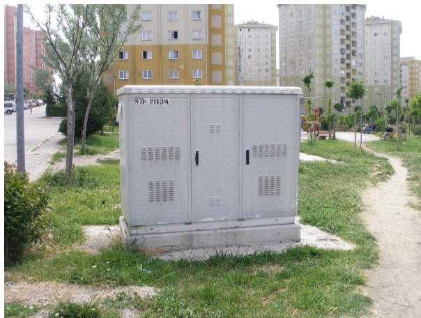
Şekil 5.25 Yerleşimdeki korunmasız trafolar
