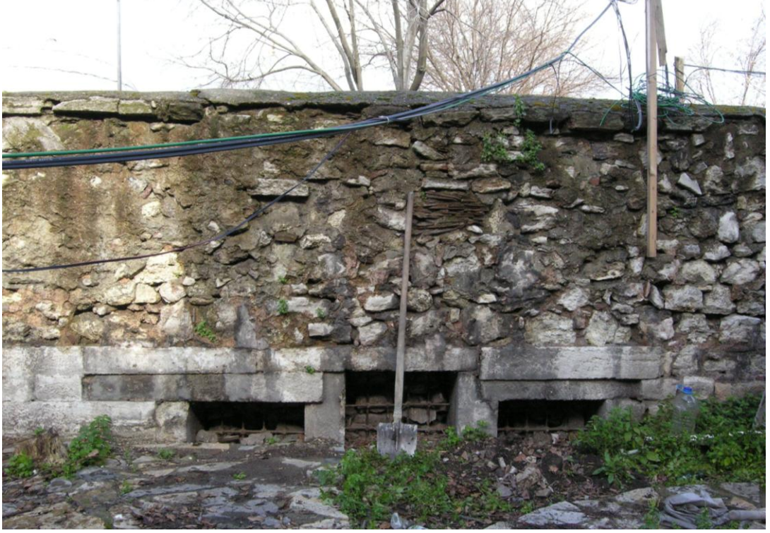
Şekil 4.7 Mevcut bahçe duvarı pencerelerinin kot yükselmesi sonucu kapanması (Kudeb).
