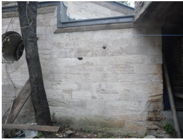
Şekil 4.41 Komşu parselde yer alan ve yapıya zarar veren akçaağaç, 2010 (Kudeb).
