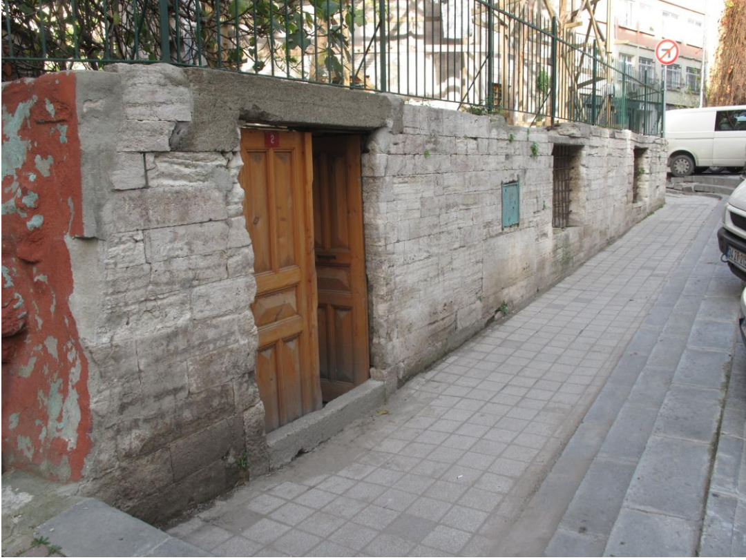
Şekil 4.51 Geç dönem onarımda yapılan ahşap bahçe kapısı (Kudeb).
