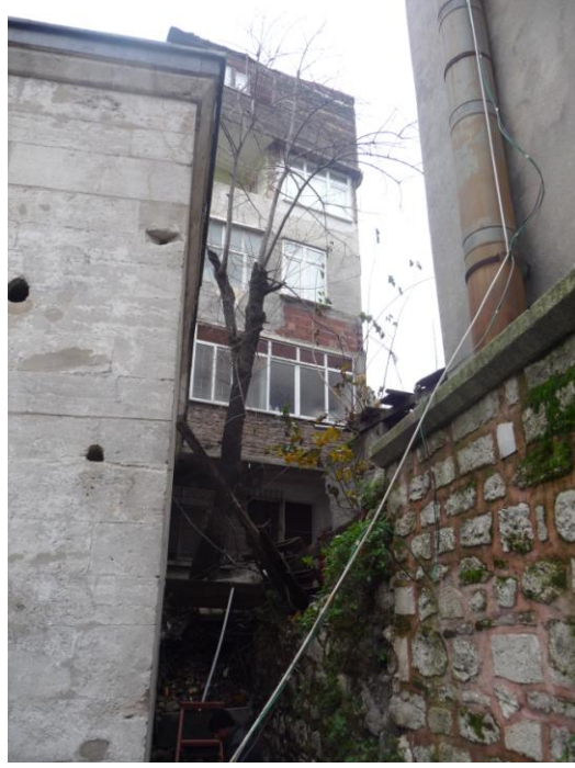
Şekil 4.40 Komşu parselde yer alan ve yapıya zarar veren akçaağaç, 2010 (Kudeb).
