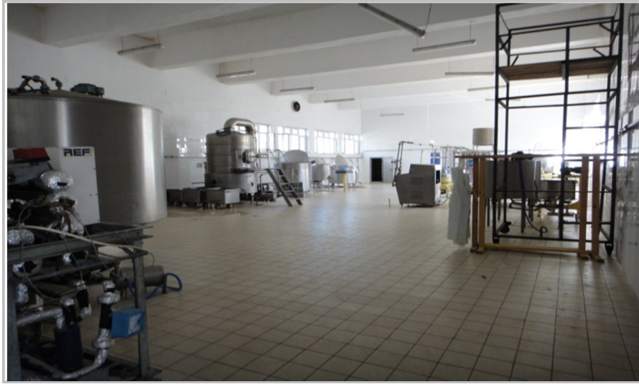
Şekil 2.1. Pilot tesisin genel görünüşü
