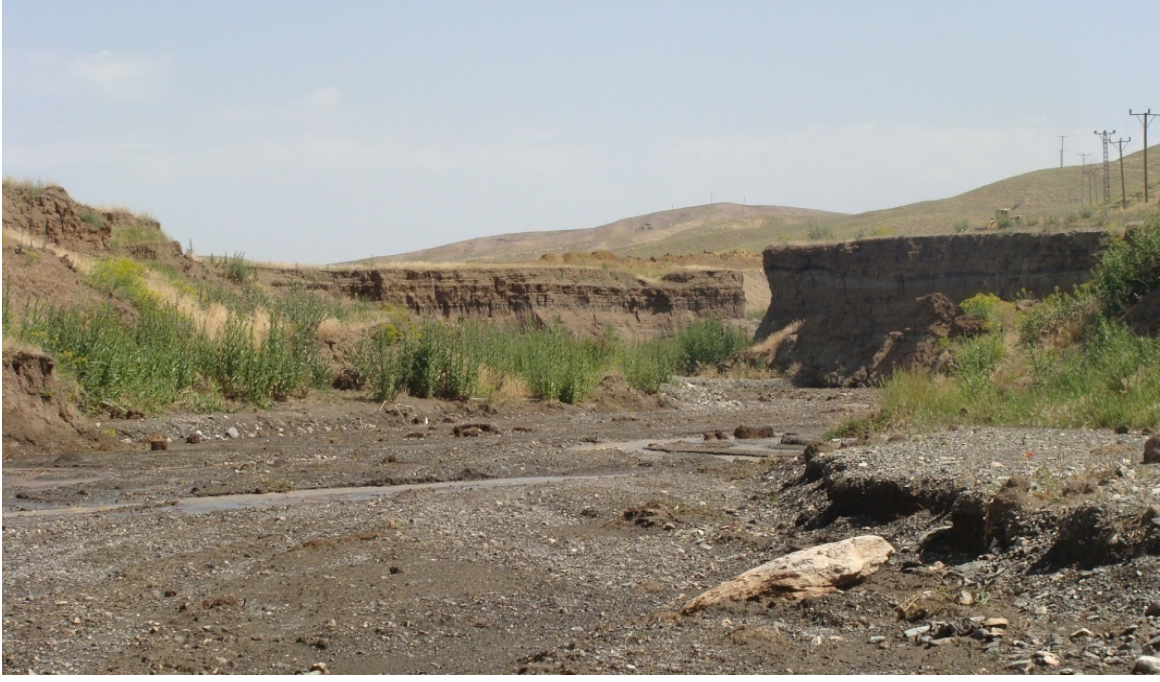
Foto 18. Karakoç Deresinde sel sonucu zeminde oluşan toprak yarılmaları
