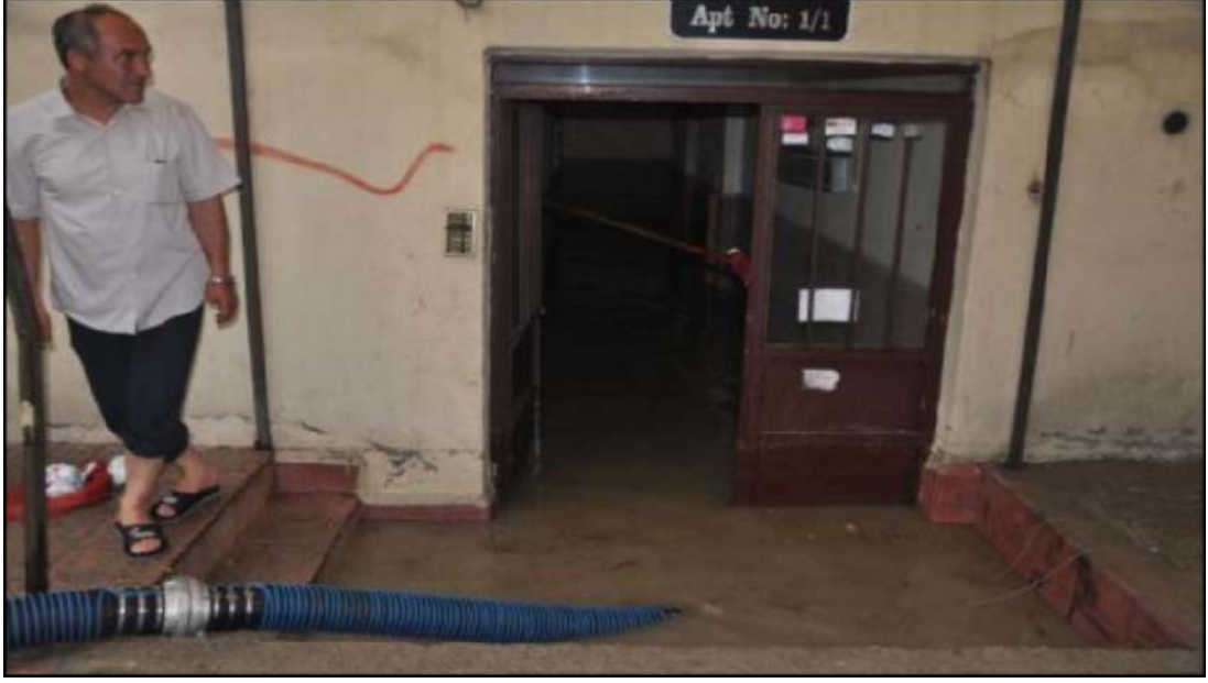
Foto 37 : Bolu’da Altyapının Yetersiz Olması Nedeni ile Yağıştan Sonra Bir Binanın Zemînine Yağmur Sularının Dolduğu Görüntüsü
