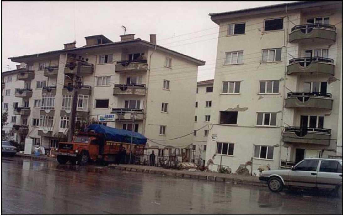
Foto 21 : 1999 Depremlerinde (17 Ağustos Marmara ve 12 Kasım Düzce Depremleri) Hasar Gören Binaların Görüntüsü
