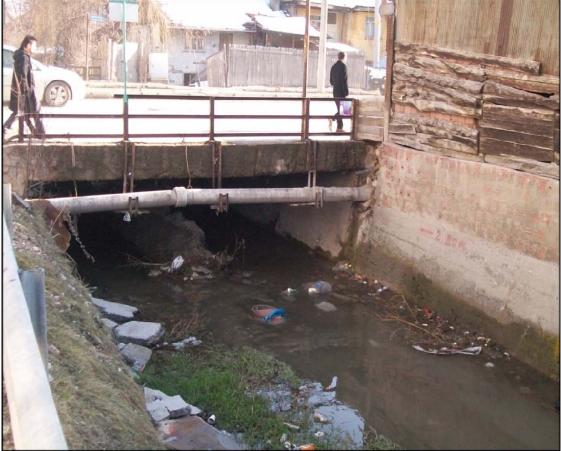
Foto 34 : Borazanlar Deresi Köprü Altında Suyun Akışını Engelleyen İnşaat Atıkları Görüntüsü
