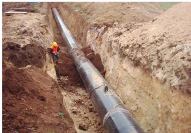
Şekil 2. 1. Doğalgaz boru hattının görünüşü.
