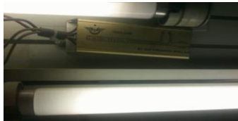
Resim 6.2: Endirekt aydınlatma elemanları
