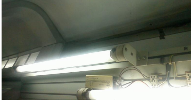
Resim 5.3: Vagon 24 V DC aydınlatma armatürünün iç görünüşü
