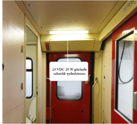
Resim 5.6: Vagon sahanlık aydınlatması (24 V DC 20 W)
