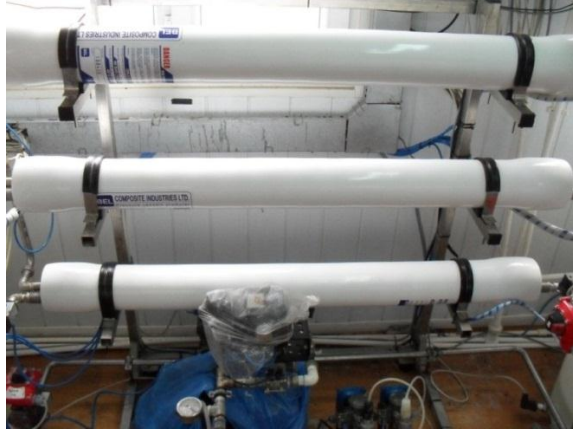
Şekil 2.8 : Birinci kademe ters osmoz sisteminin görünümü.
