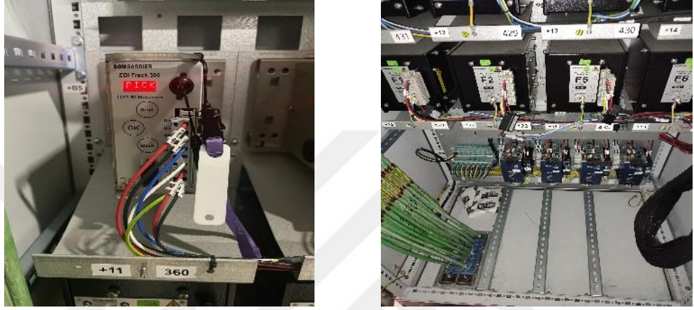
Şekil 3.16. Ray devresi kabineti; solda reciver sağda transmitter ünitesi
