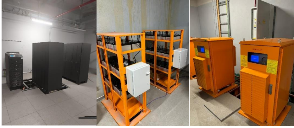
Şekil 3.23. Sol: M3 hattı UPS ve akü kabinler orta: M9 Akü kabinleri sağ: M9 UPS kabinleri
