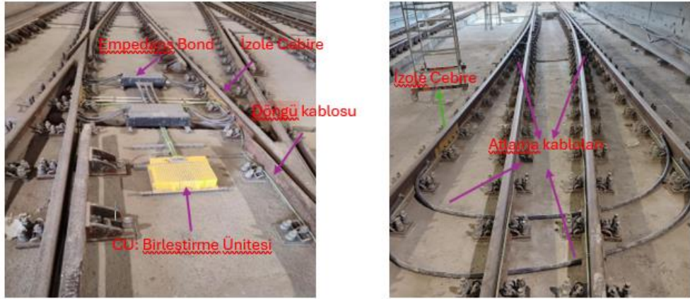
Şekil 3.5. Sol:CU, empedans bond, izole cebire, loop kablosu sağ: izole cebire ve atlama kabloları
