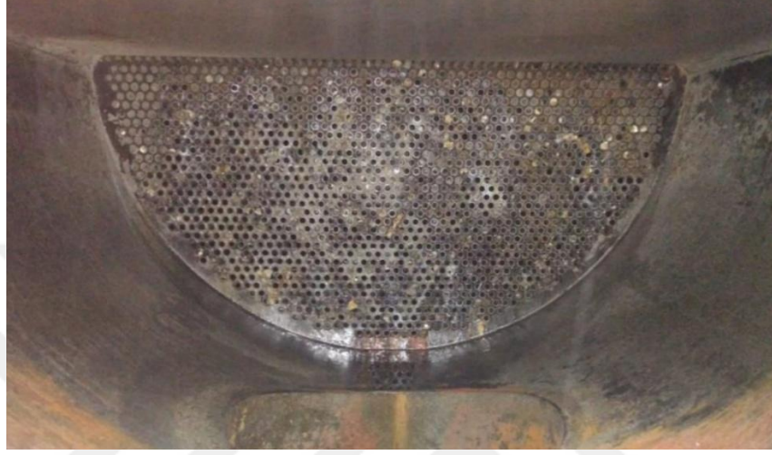
Őekil 4.1 ift evrimli jeotermal enerji santrali yüksek basın ısı eřanjörü kalsiyum kabuklařması
