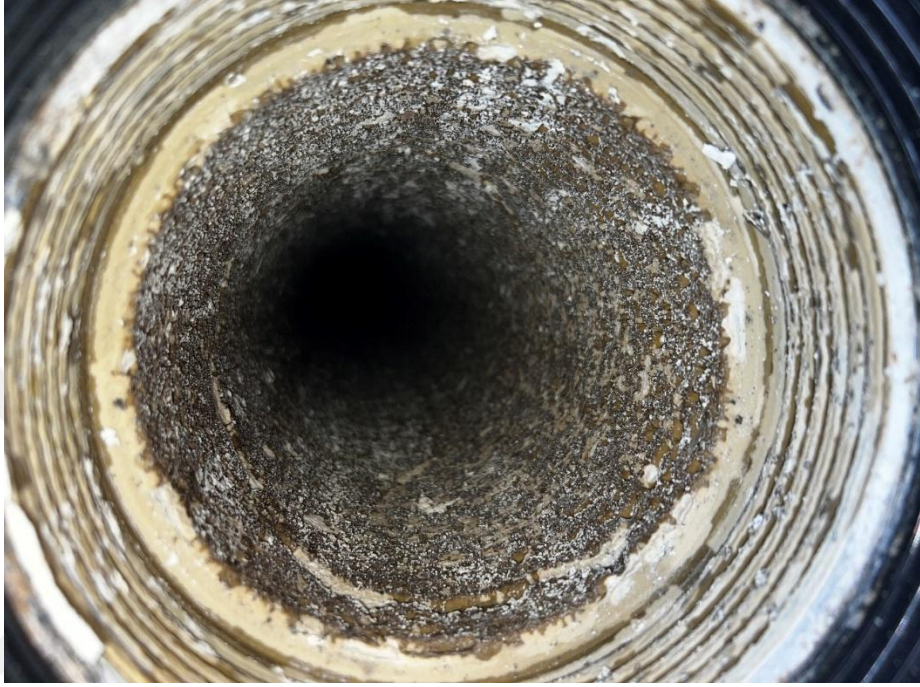
Şekil 4.3 Çift çevrimli jeotermal enerji santrali boru hattında oluşan kalsiyum ve silisyum yapıları kabuklaşma
