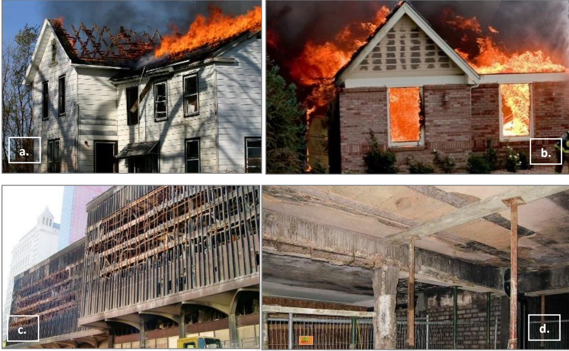
Resim 2.1. Yapılarda ısıya maruz kalmanın neden olduğu yapısal hasar örnekleri (a. Yangında zarar görmüş ahşap yapı (Sams, 2022), b. Yangında zarar görmüş PVC pencere çerçevesi (Connolly, 2013), c. Kulelerden düşen molozlar nedeniyle dış duvar çelik iskeleti hasar gören WTC 5 binası (Gewain vd. 2002), d. Yangın nedeniyle giriş ve kolonlarda beton dökülmesi (Rogerson ve Sabra, 2024))
