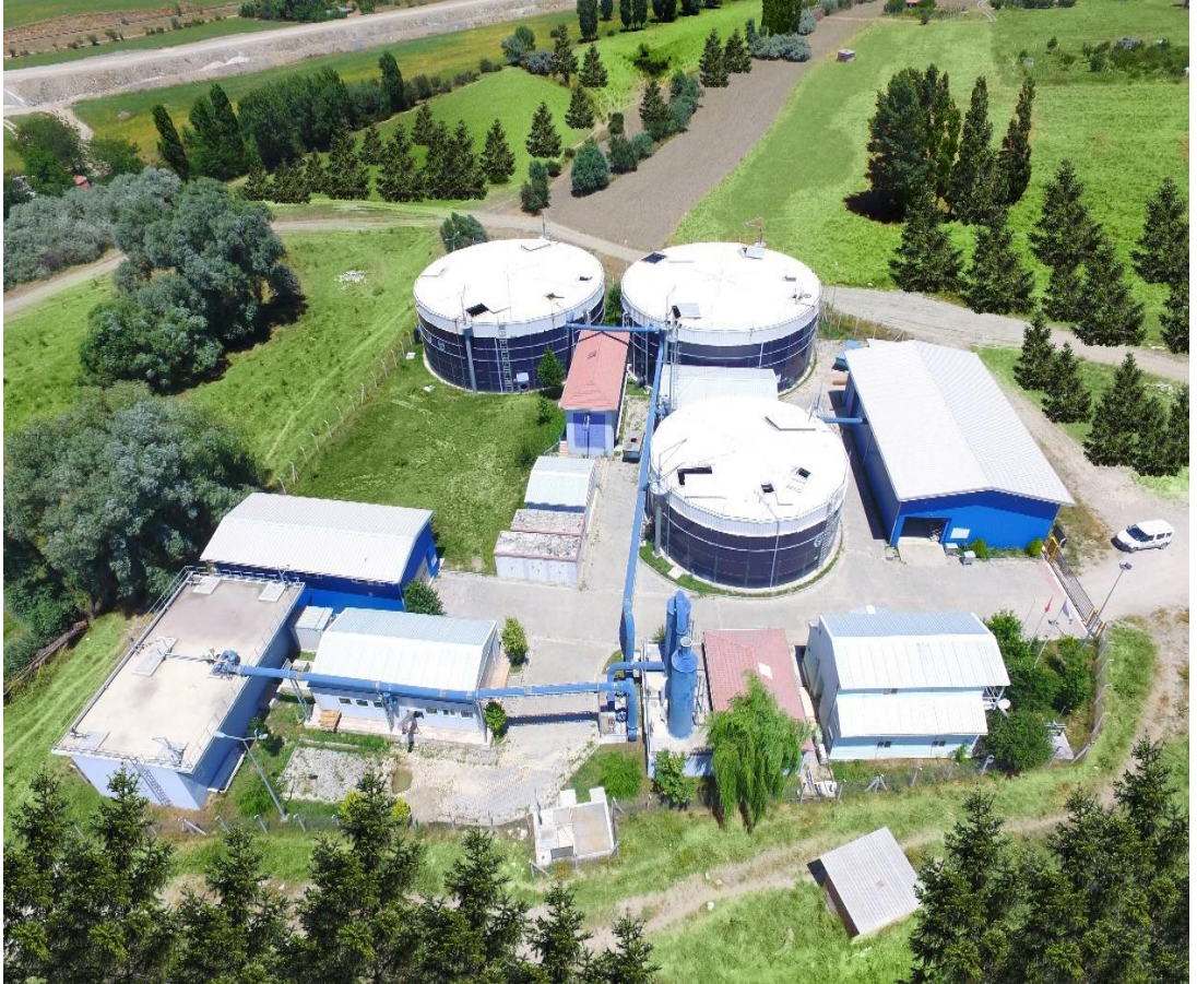
Şekil 4.1. Hasanoğlan atıksu arıtma tesisi
