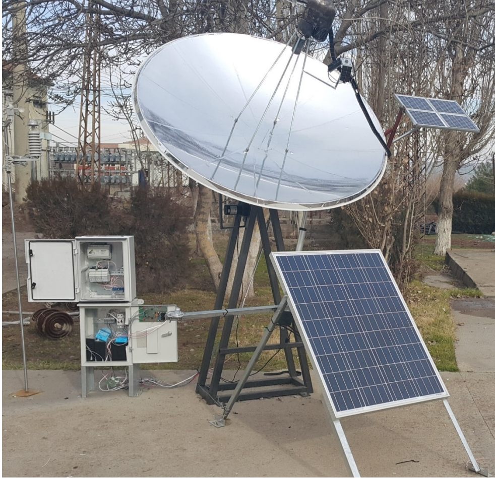
Şekil 6. SMGTS'ye ait kurulumu tamamlanmış sistem görünümü
