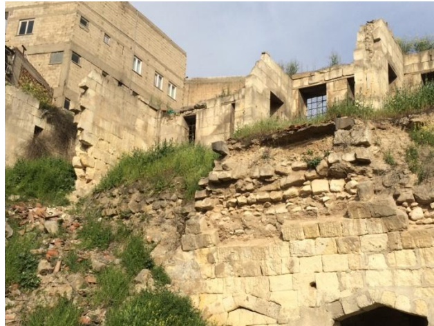
Şekil 6.17: Emir Ali Hanı Doğu Cephe Yıkılan Mekânlar Görünüş
