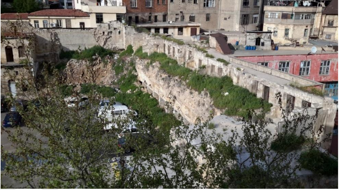
Şekil 6.26: Emir Ali Hanı Doğu Cephe Yıkılan Mekânlar
