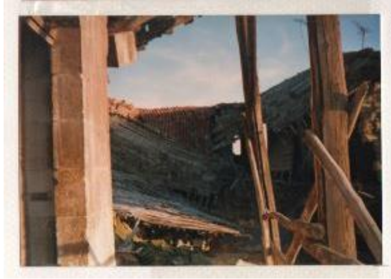
Şekil 6.40: Emir Ali Hanı Yıkılan Çatı Detayı (Gaziantep Kültür Varlıklarını Koruma Bölge Kurulu Müdürlüğü Arşivi)
