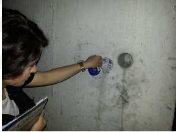
Şekil 6.8. Mikro covermeter ile donatı tespiti çalışması
