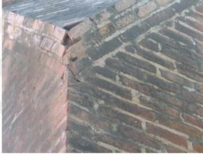
Şekil 3.19. Dış cephe bölümündeki siyah tabaka oluşumları.
