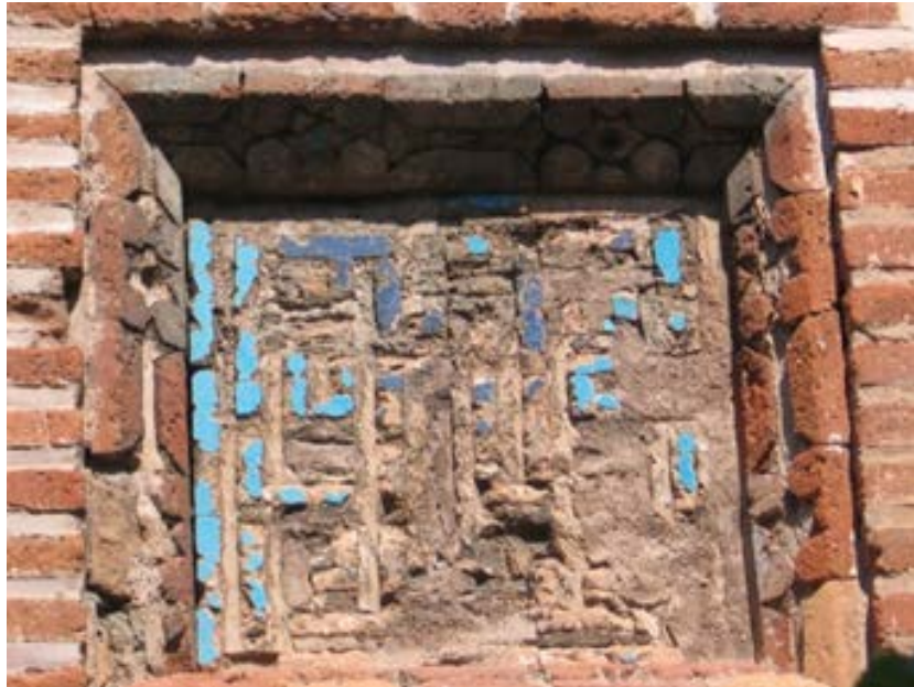
Şekil 3.16. Yivli Minare tuğla bölümlerindeki parça kayıpları.
