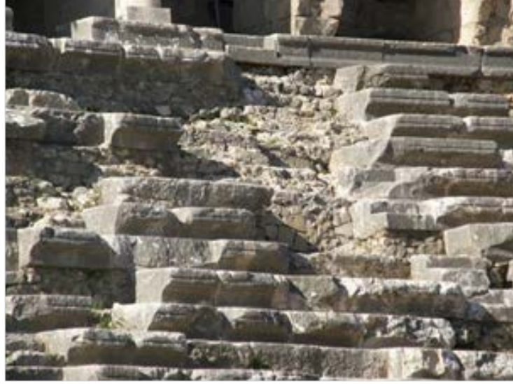
Şekil 3.39. Yapı elemanlarındaki çeşitli parça kayıpları.
