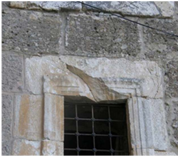
Şekil 3.34. Yapıdaki 0.5 – 2 cm. kadar olanlar çatlaklar.
