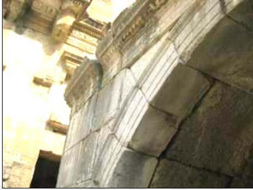
Şekil 3.36. Yapıdaki derz açılmaları.
