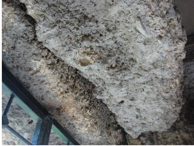
Şekil 3.35. Yapıdaki 0.5 – 2 cm. kadar olanlar çatlaklar.
