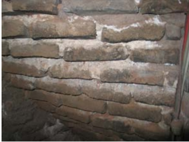
Şekil 3.15. Yivli Minare tuğla bölümlerinde derz açılmaları ve boşalmaları.
