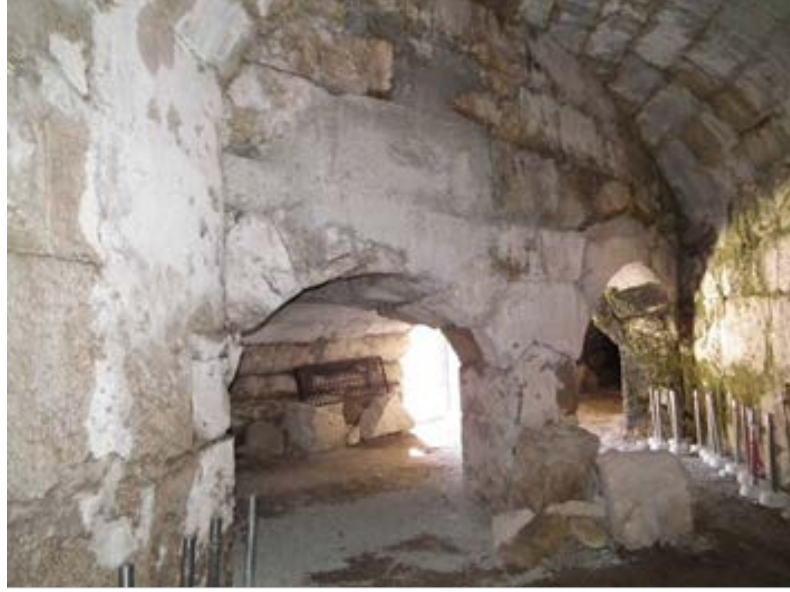
Şekil 3.40. Yapıdaki nem ve tuz çıkışları.
