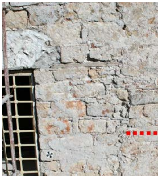
Şekil 3.12. Yivli Minare Camii bölümü duvarlarındaki çatlak ve yarıklar.
