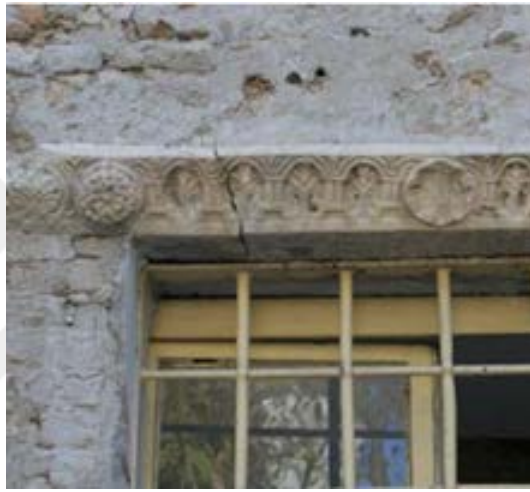
Şekil 3.11. Yivli Minare Camii bölümündeki çatlak ve yarıklar.
