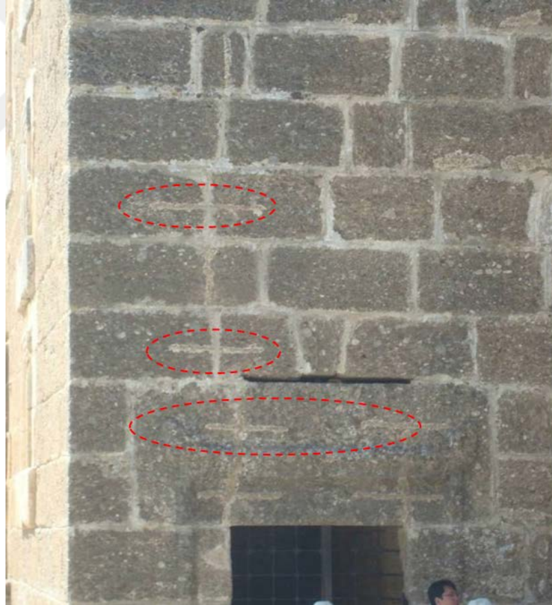
Şekil 3.37. Yapıdaki derz açılmaları taşların yatay yönde, üzeri sonradan kireçli bir harçla kapatılan (“U” şeklinde) kenet uygulaması.
