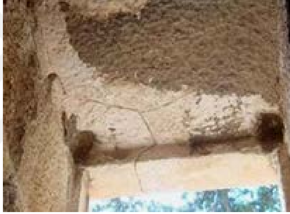
Şekil 3.33. Yapıdaki 0.5 cm kadar olan çatlaklar.
