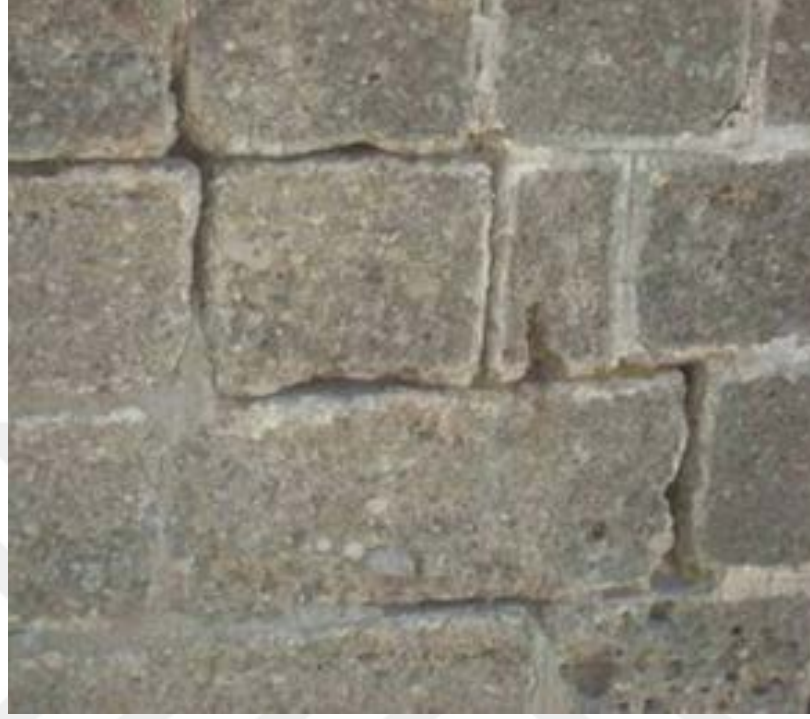
Şekil 3.38. Yapı beden duvarındaki derz boşalması.
