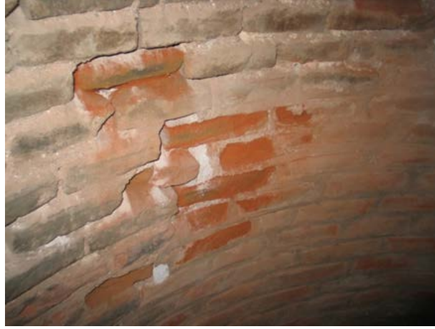
Yivli Minare iç duvarlarındaki çatlak ve yarıklar.
