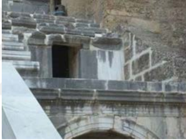
Şekil 3.42. Yapıdaki siyah tabaka oluşumları.
