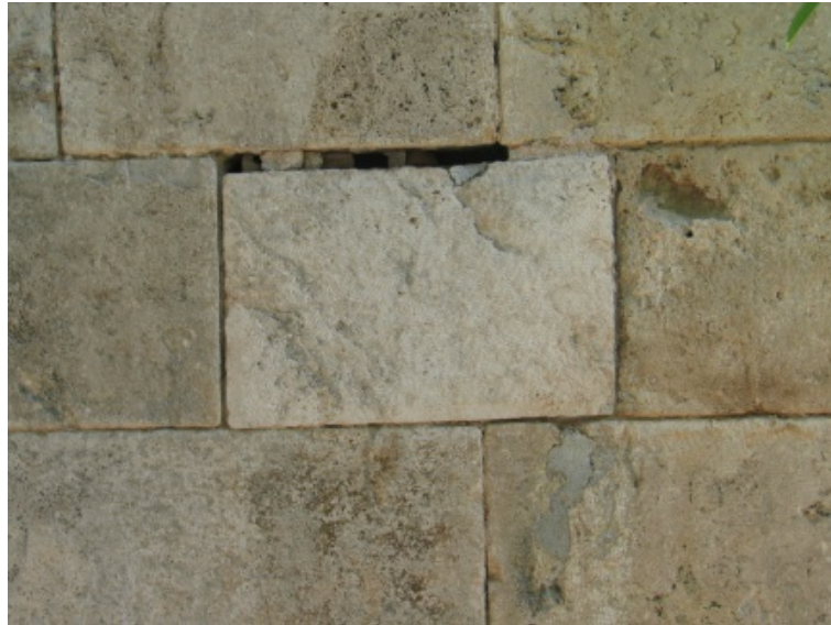
Şekil 3.14. Yivli Minare taş duvar bölümlerinde derz açılmaları ve boşalmaları.
