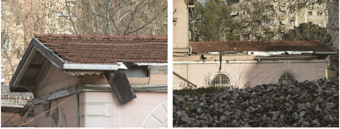
Şekil 63 - İstasyon kanopisinin sökümü sonrasında yapıda oluşan hasar
