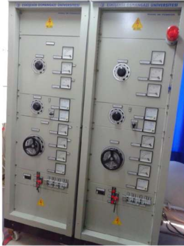
Şekil 4.8. Katot akımı güç kaynağı ve anot potansiyeli güç kaynağı panosu.
