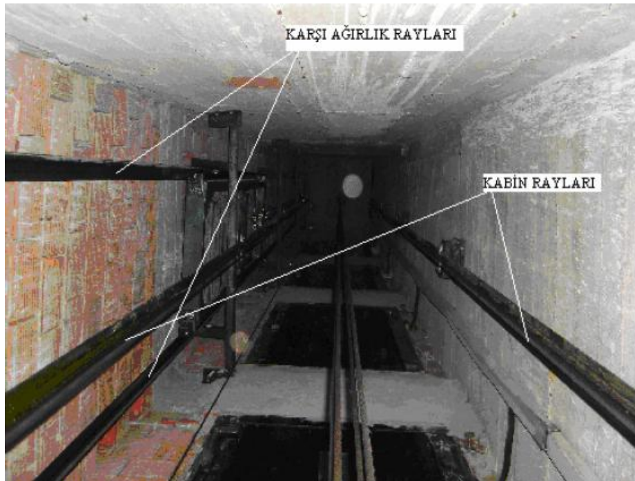
Şekil 3.8 : Kuyu içerisine yerleştirilen kabin ve karşı ağırlık kılavuz rayları
