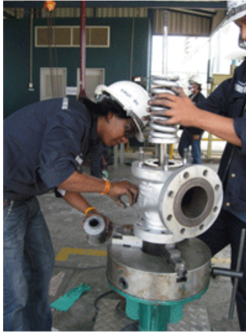
Şekil 2.5 : Emniyet vanası bakım örneği [82].
