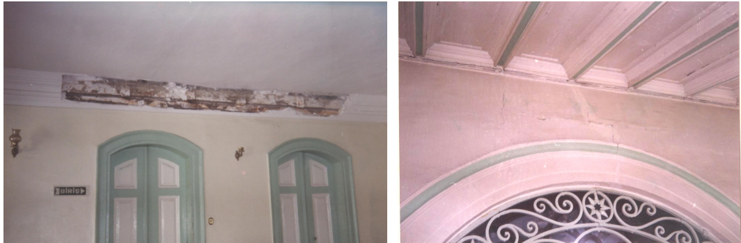
Şekil 5.11. Duvar ile döşemelerin birleşim noktalarında ve pencere üstü kemerlerdeki hasarlar
