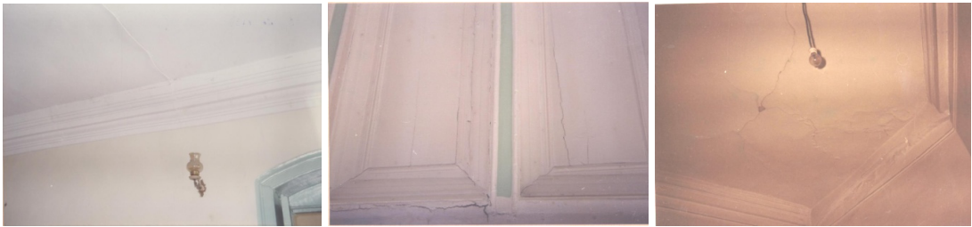
Şekil 5.12. Tavanlarda meydana gelen hasarlar
